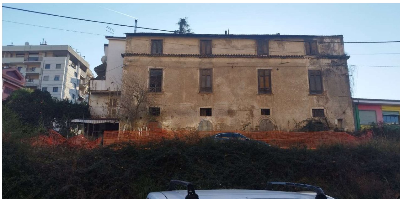
FOTO N°8: FABBRICATO DA DEMOLIRE, P.LLA N°1226, PROSPETTO EST;
