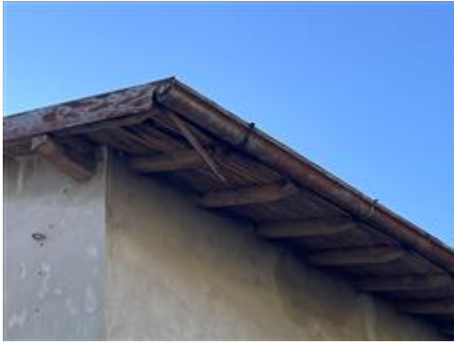
danni alla copertura comune
