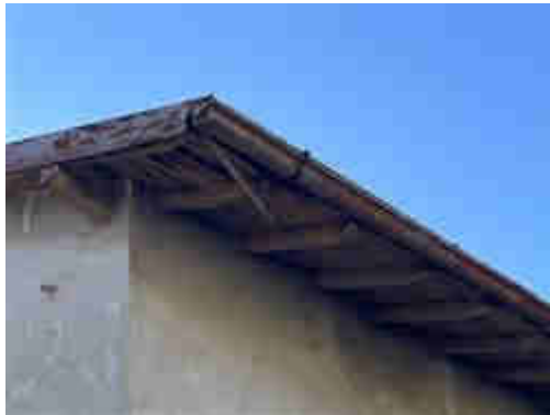
danni alla copertura comune
