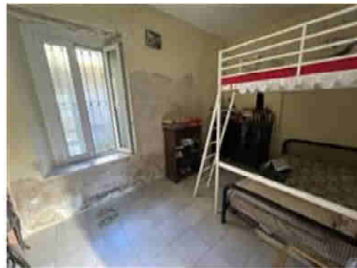
camera 2: evidenti segni di umidità di risalita
