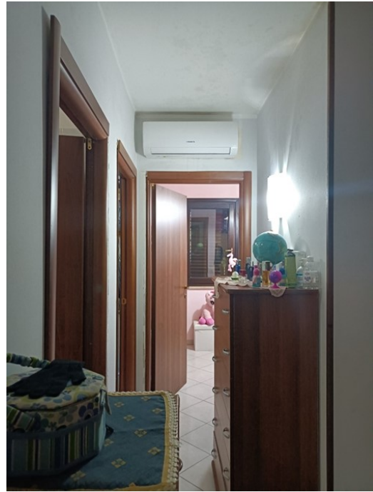
Foto n° 19 (porta interna disimpegno con coprifili mancanti)
