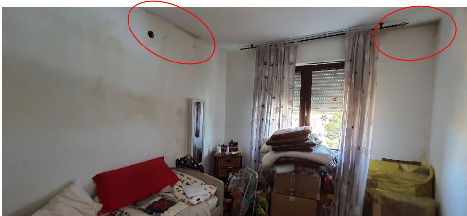
Dettagli umidità condensa camera 2
