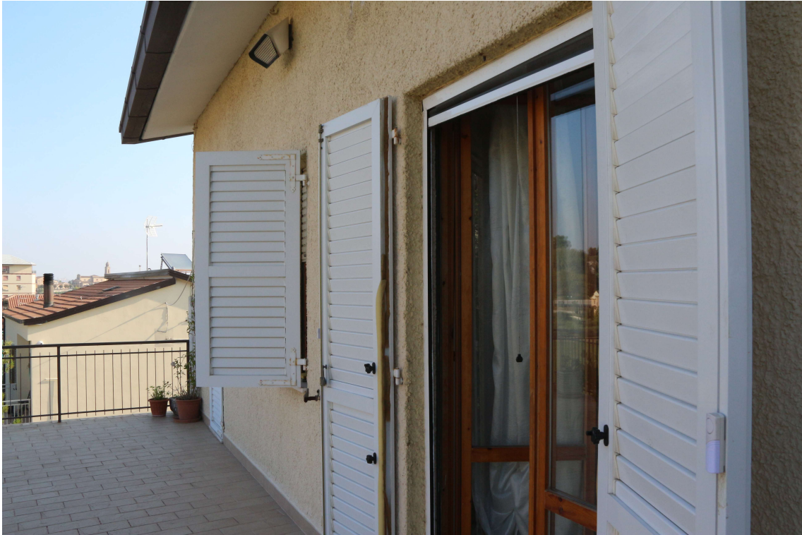
FOTO 11 – VISTA ESTERNA VERSO NORD PARETE LATO OVEST 1° PIANO
