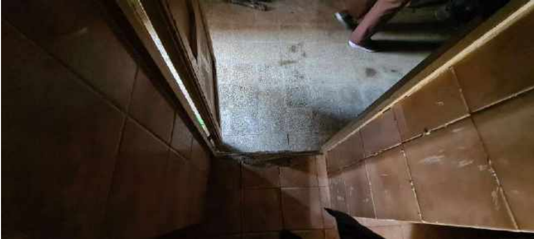
Particolare Gradino – dislivello tra vano ingresso/cucina e servizio igienico
