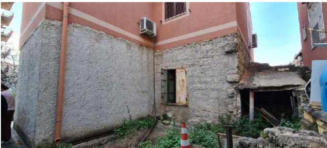
Magazzino/locale deposito-Infisso vano pranzo - Retrospetto
