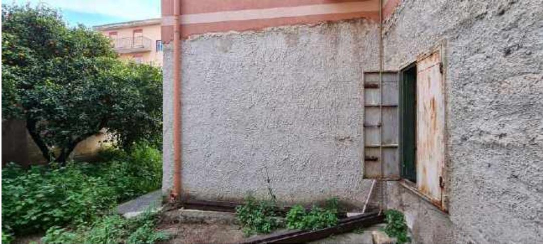
Magazzino/locale deposito-Infisso vano pranzo – Retrospetto
