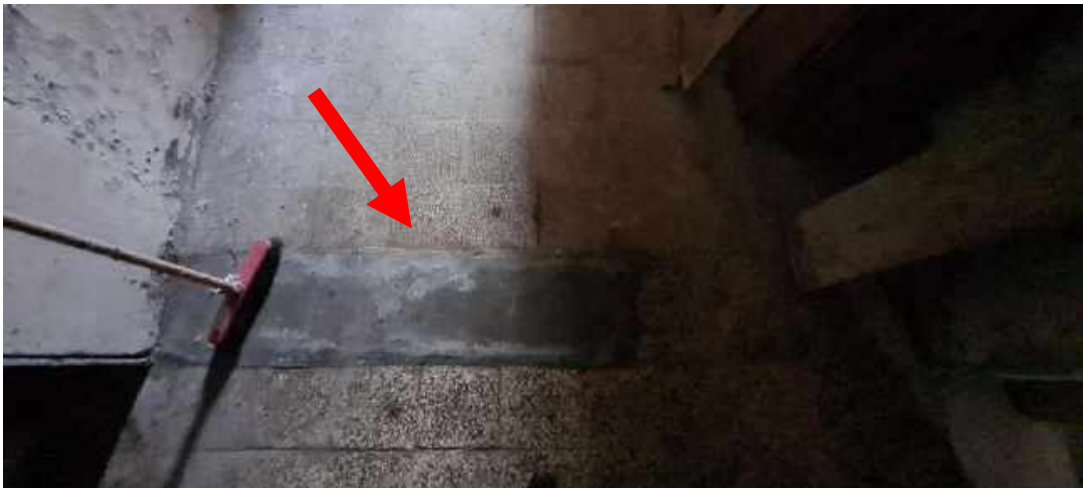
Porzione di tramezzo demolito tra il vano ingresso/cucina ed il vano soggiorno
