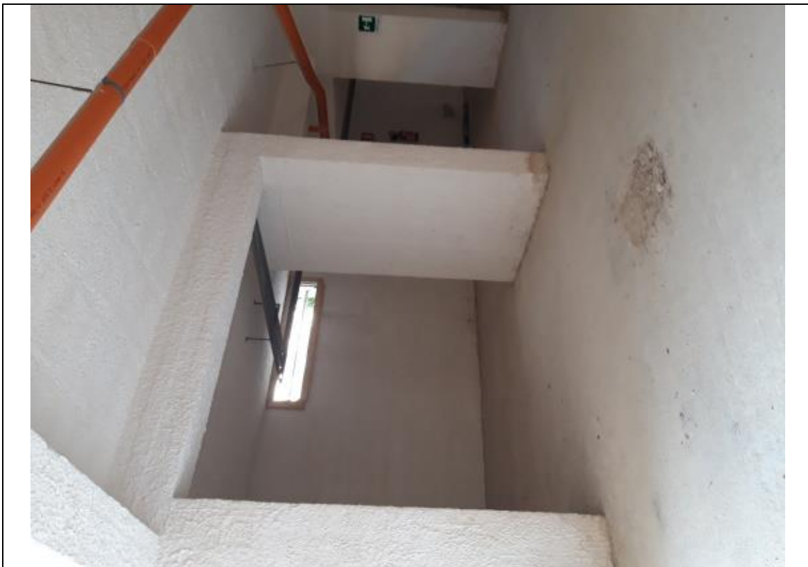
Foto 01 – Vista posto auto sub 14 (a dx della foto) – in corrispondenza della tubazione.-
