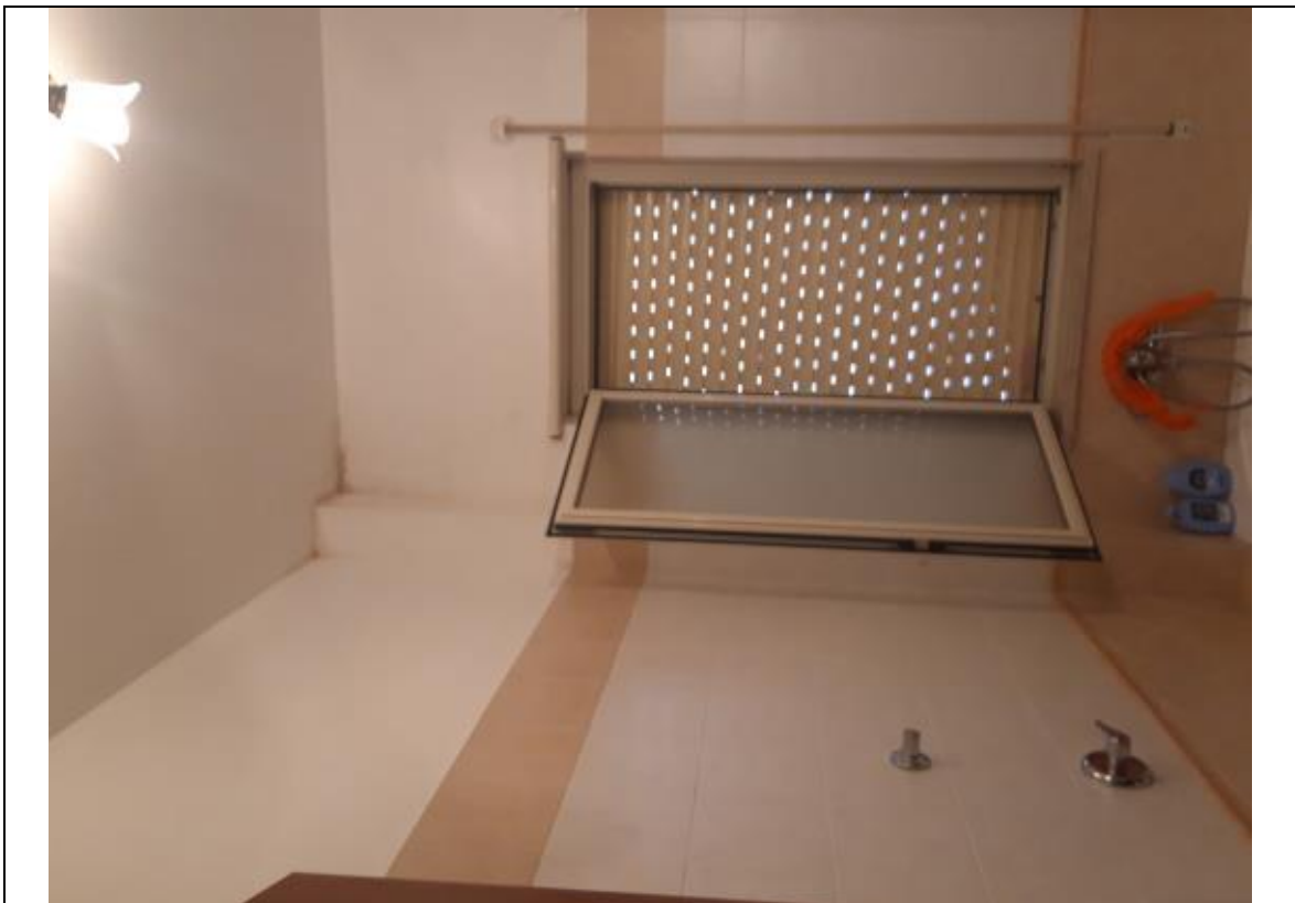
Foto 16 – Vista interna – infiltrazioni sul soffitto.-
