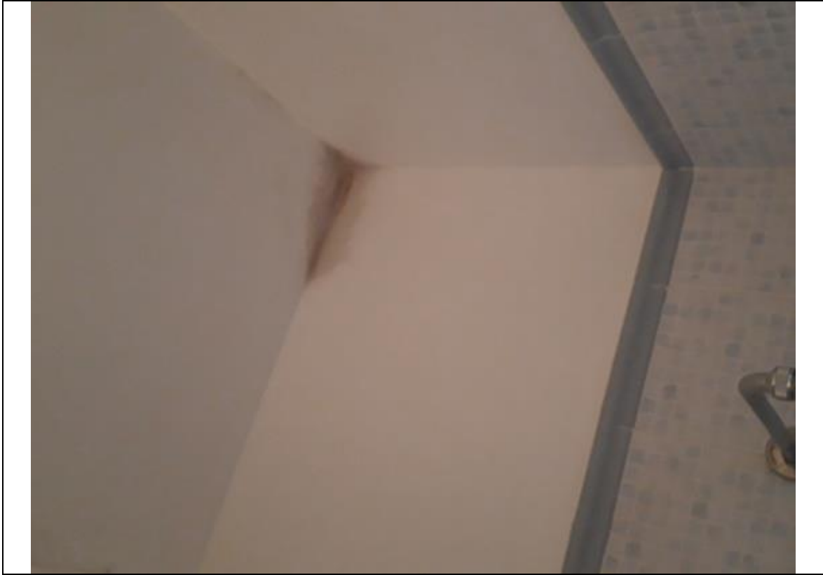
Foto 15 – Vista interna – infiltrazioni sul soffitto.-
