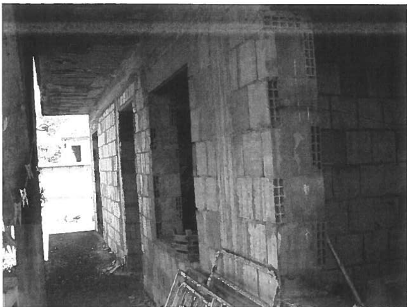
FOTO N. 6 – rottura laterizi solaio sbalzi –
