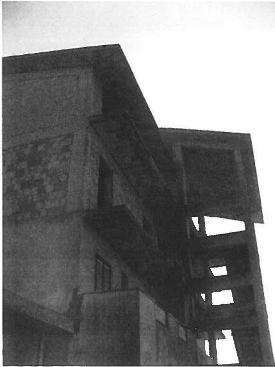
FOTO N. 11 – Balconi piano 2° e 3° - vano scale-
