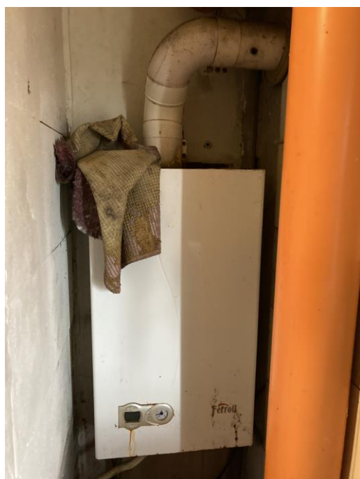
Caldaia (posta in bagno)
