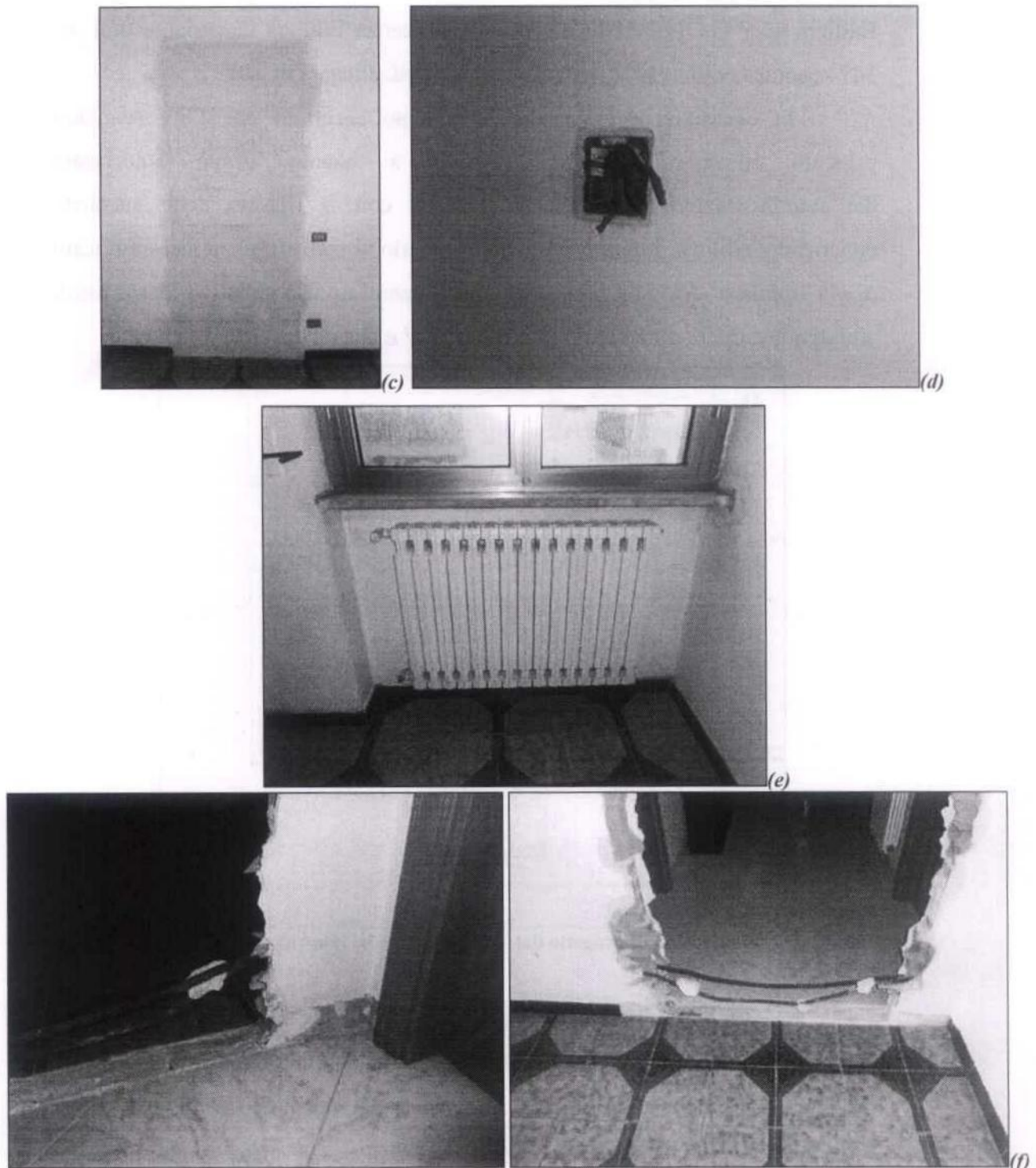
Figura n° 6. Fotografie dell'appartamento: camera riaccorpata (a); vano porta allo stato grezzo di accesso alla camera (b); vano porta murato sulla parete Ovest della camera (c); dettaglio dell'impianto elettrico da ripristinare (d); elemento radiante da collegare all'impianto di riscaldamento (e); dettagli dei battiscopa da ripristinare (f).
