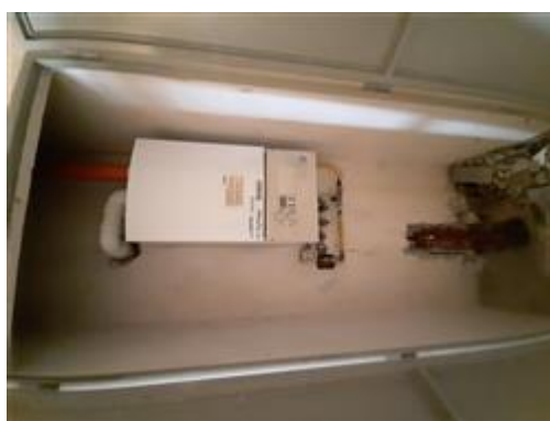
nicchia fra le cantine condominiali, con caldaia murale
