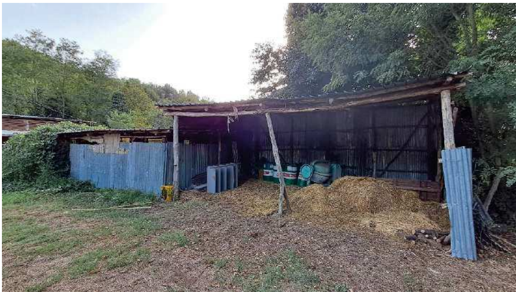
Foto 11: Catasto Terreni di Cittanova, foglio 60, particella 12 – Il fabbricato contrassegnato con la lettera “d”, in pessime condizioni di manutenzione e conservazione, consiste in un manufatto adibito a deposito con annessa tettoia.
