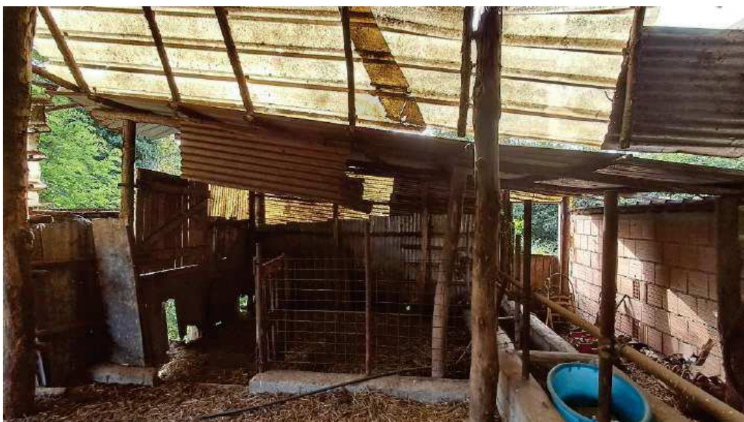
Foto 8: Catasto Terreni di Cittanova, foglio 60, particella 12 – Manufatto addossato al lato ovest del fabbricato contrassegnato con la lettera “c”, in pessime condizioni di manutenzione, è stato realizzato con una struttura in pali di legno, pareti e tetto ricoperti da fogli di lamiera di metallo e di vetroresina.
