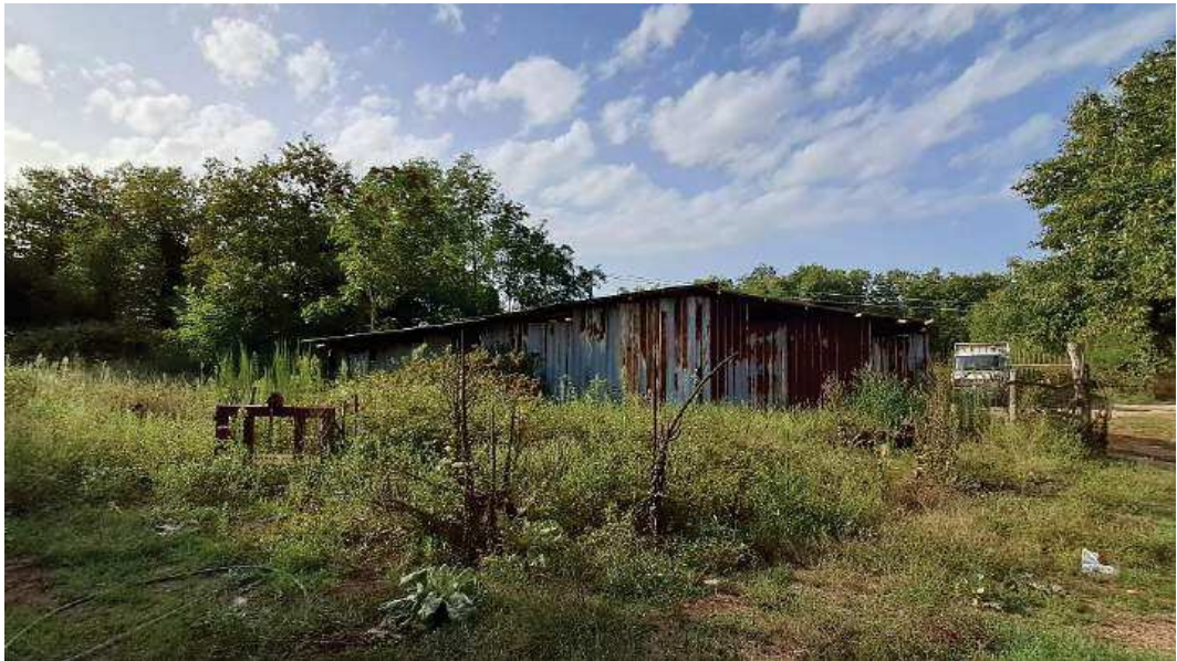
Foto 4: Catasto Terreni di Cittanova, foglio 60, particella 12 – Il fabbricato contrassegnato con la lettera “b”, in stato di abbandono ed in pessime condizioni di manutenzione e conservazione, adibito un tempo a stalla, è stato realizzato con una struttura in pali di legno, pareti e tetto ricoperti da fogli di lamiera di metallo.
