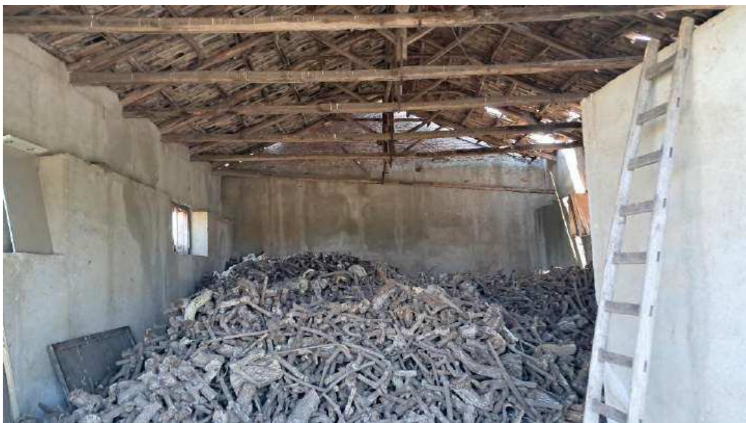
Foto 10: Catasto Terreni di Taurianova, foglio 18, particelle 12 e 13 – Fabbricato “b” - deposito in precarie condizioni di conservazione con cedimenti della struttura del tetto.
