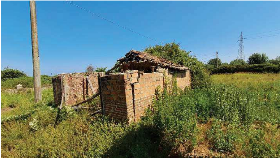
Foto 9: Catasto Terreni di Taurianova, foglio 18, particella 12 – Fabbricato “a” -deposito in parte crollato.
