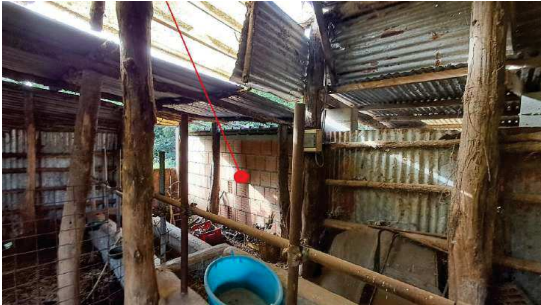
Foto 9: Catasto Terreni di Cittanova, foglio 60, particella 12 – Manufatto addossato allo spigolo nord-ovest del fabbricato contrassegnato con la lettera “c”, in cattive condizioni di manutenzione, è stato realizzato con una struttura in muratura non intonacata e tetto ricoperto da fogli di lamiera di metallo.
