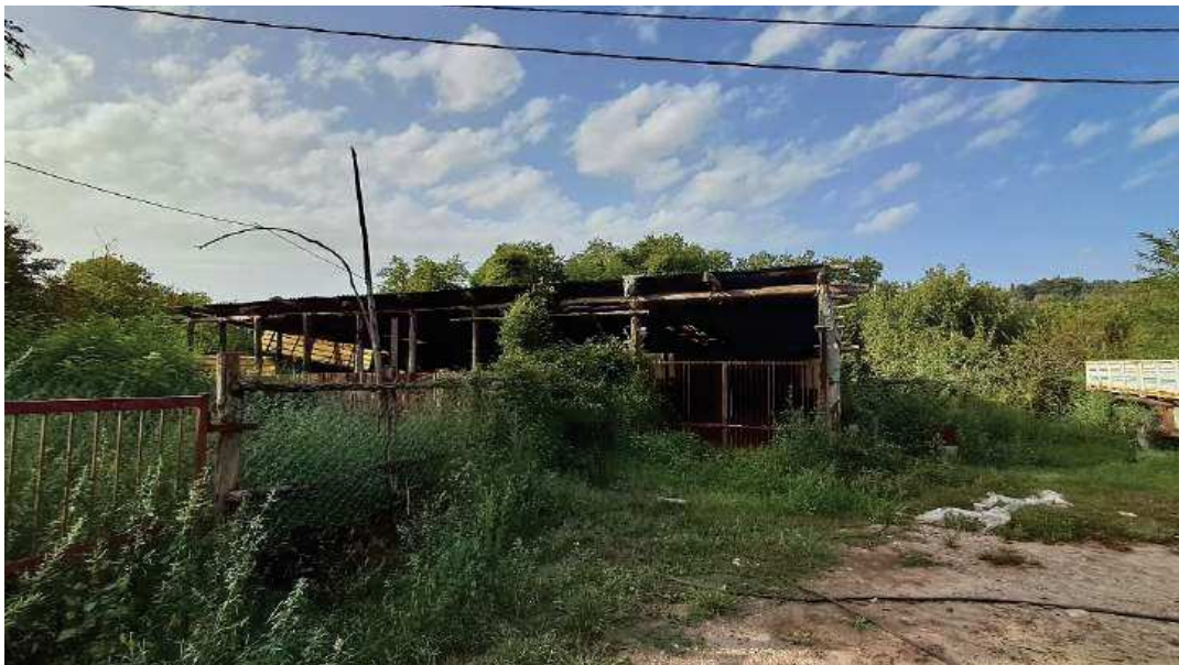
Foto 6: Catasto Terreni di Cittanova, foglio 60, particella 12 – Il fabbricato contrassegnato con la lettera “c”, in stato di abbandono ed in pessime condizioni di manutenzione e conservazione, adibito un tempo a stalla, è stato realizzato con una struttura in pali di legno, pareti e tetto ricoperti da fogli di lamiera di metallo.
