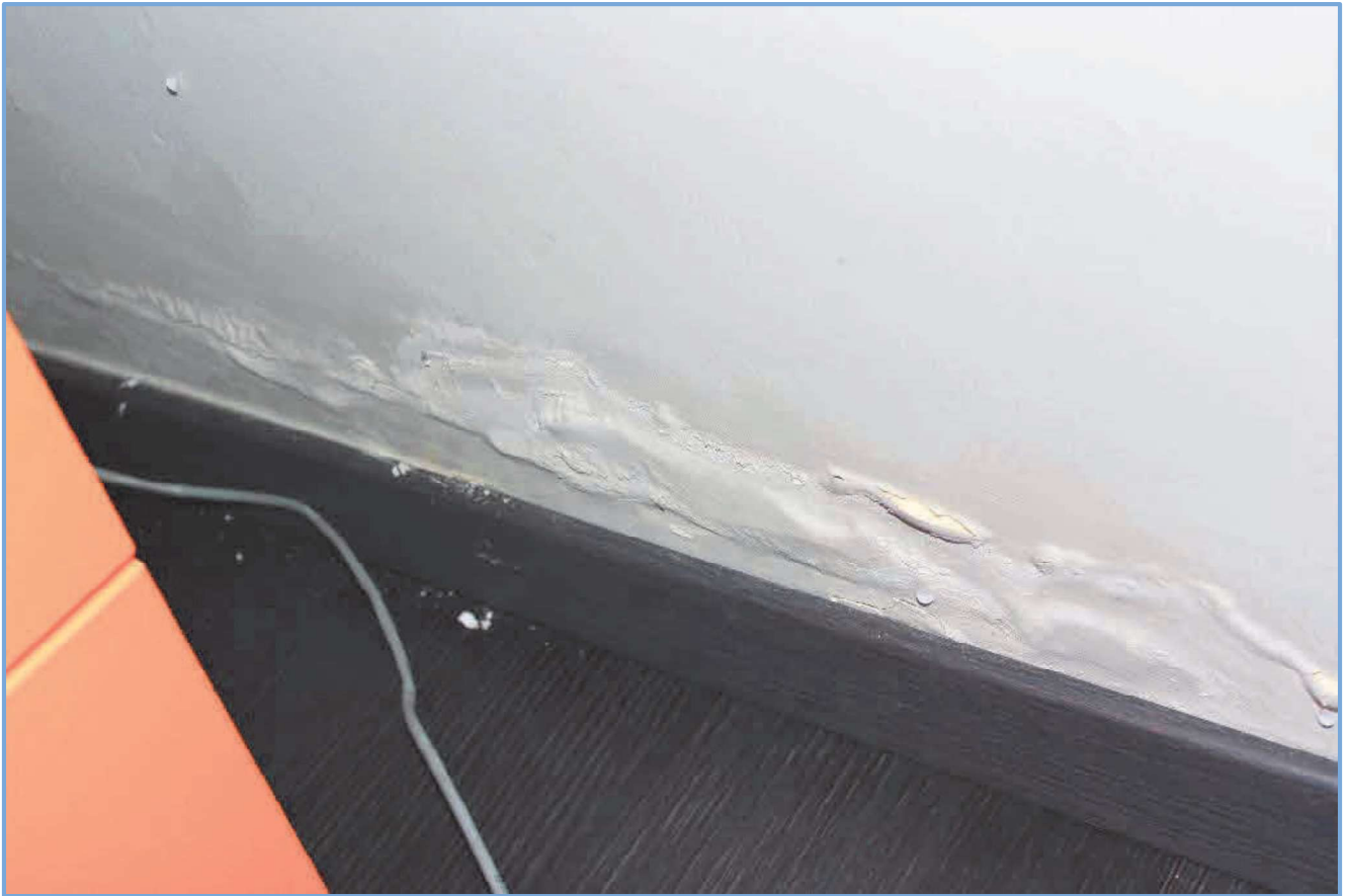
2.48 – Ufficio n° 2 – Particolare vista tracce di umidità
