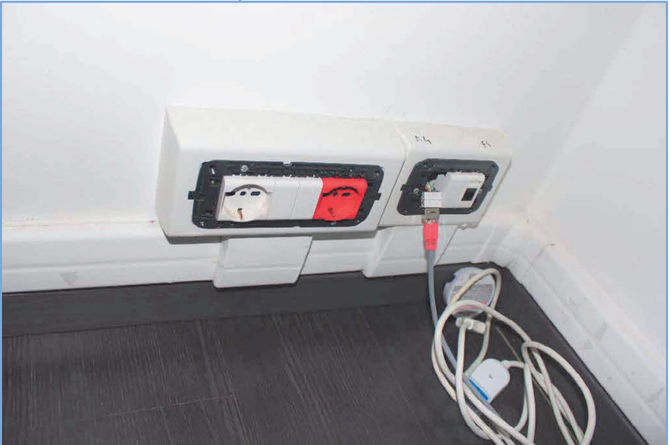
2.25 – Locale Ufficio n° 2 – Particolare prese e linea internet
