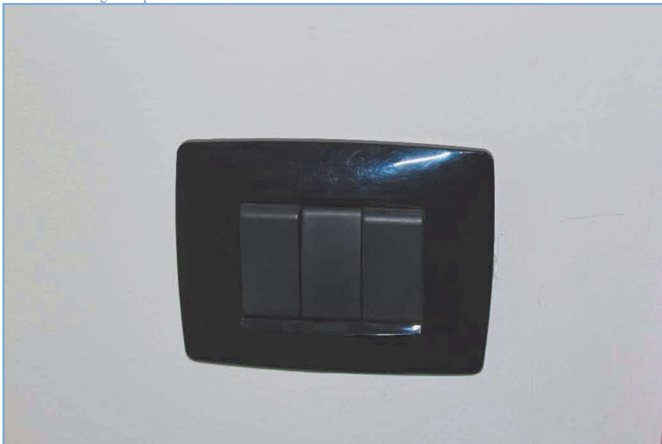
2.26 – Vista dettaglio su placca e interruttore elettrico
