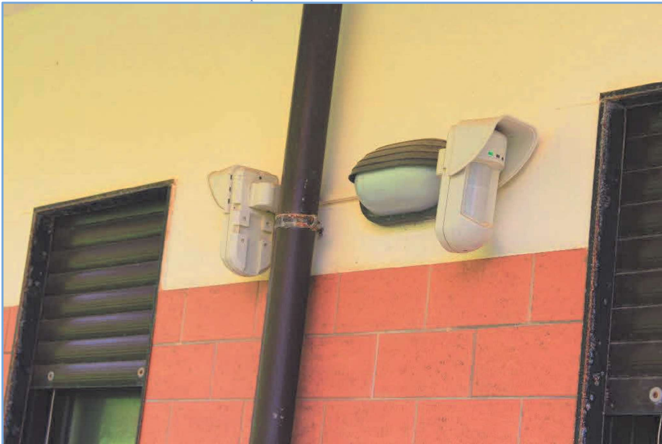
2.65 – Particolare vista sui sensori dell'impianto antintrusione
