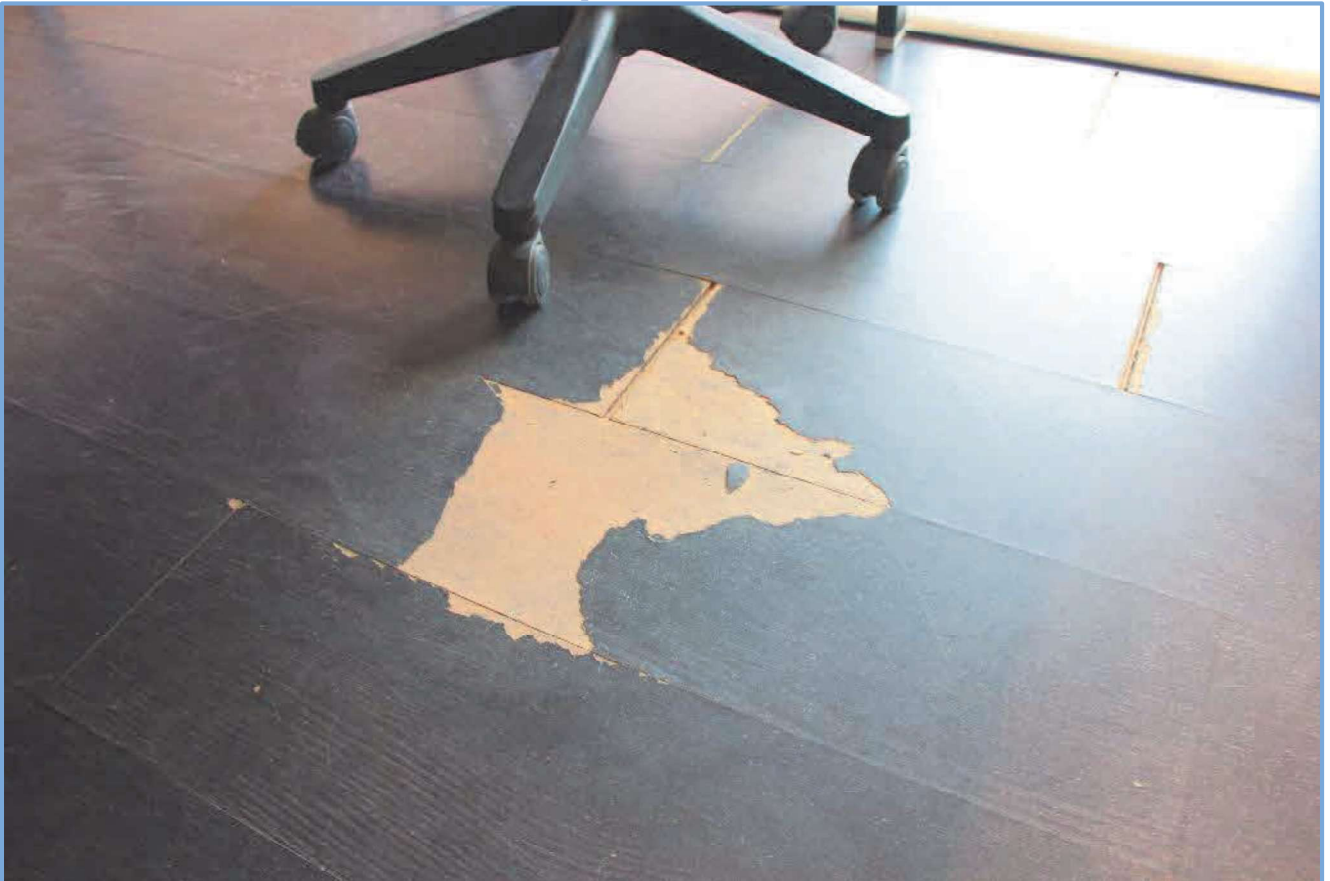
2.47 – Locale Ufficio n° 2 - Particolare usura del pavimento in laminato
