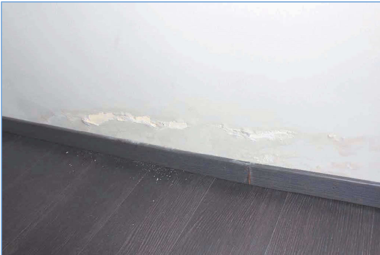
2.36 – Ufficio n° 4 – Particolare vista tracce di umidità
