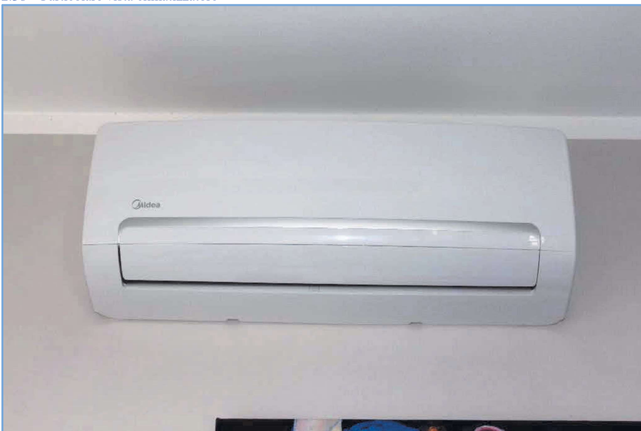
2.38 – Particolare vista climatizzatore
