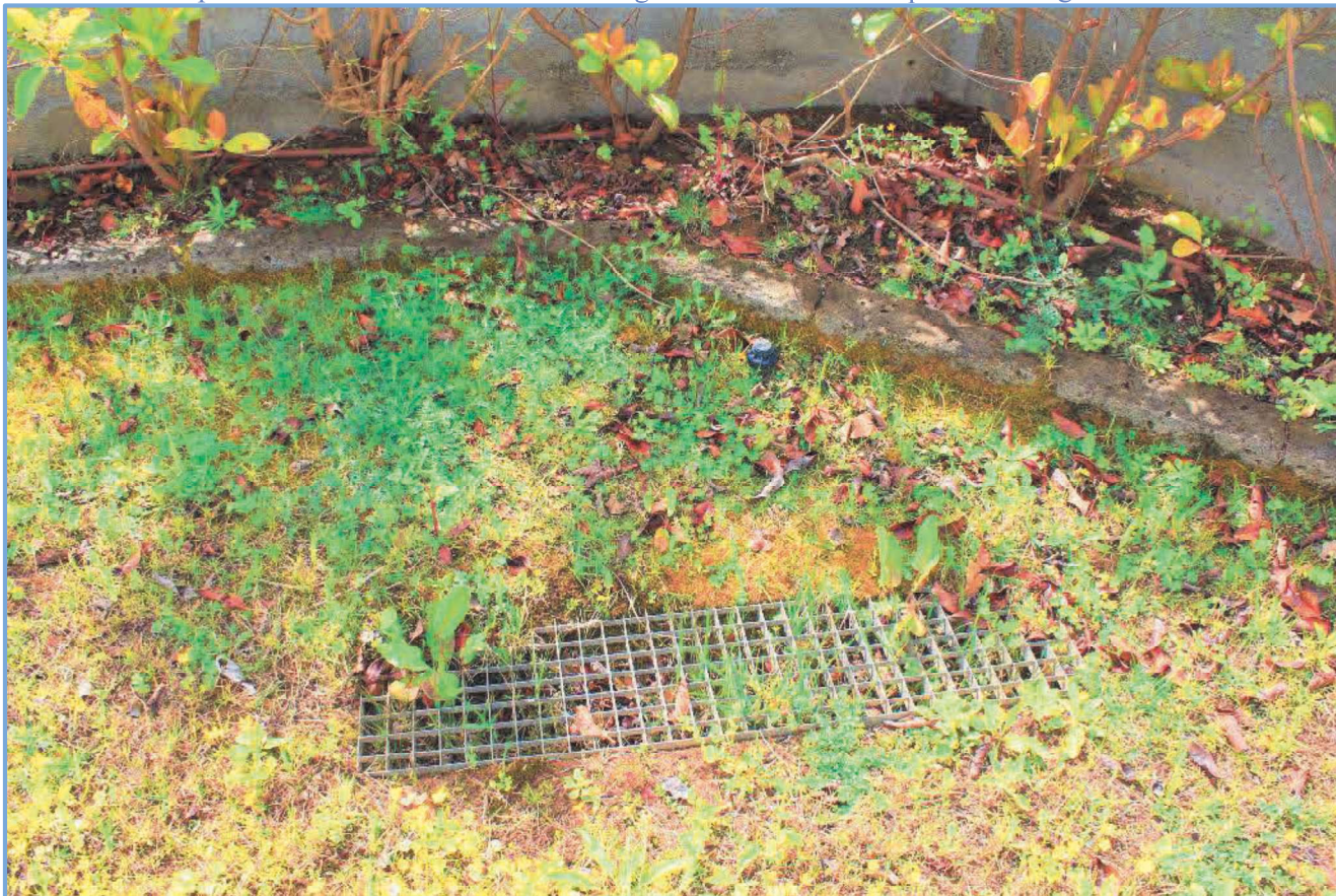
2.55 – Giardino pensile n° 2 – Particolare vista della grata di scolo e dell'impianto di irrigazione
