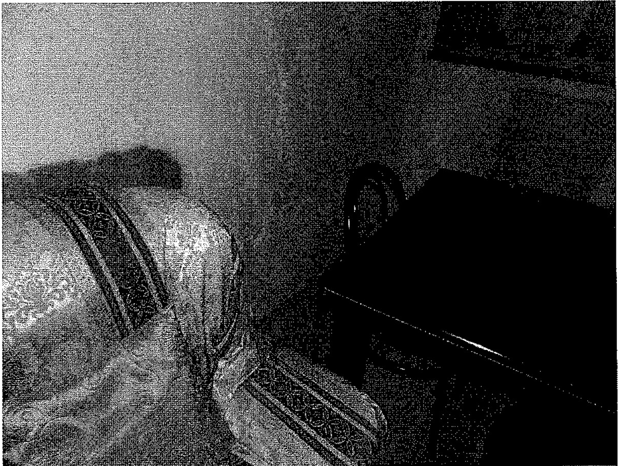
ZONA PRANZO CON TRACCE DI UMIDITA'
