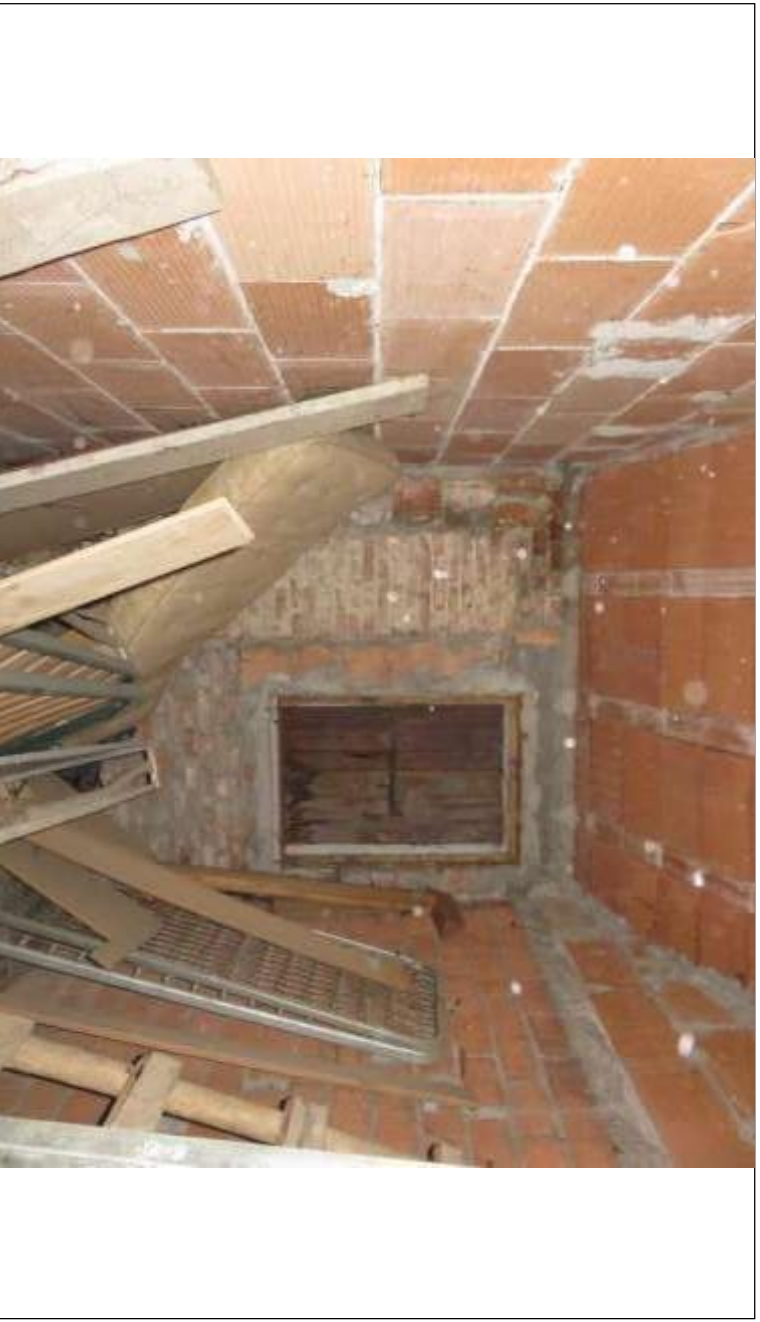
28 Vista del bagno non completato;
