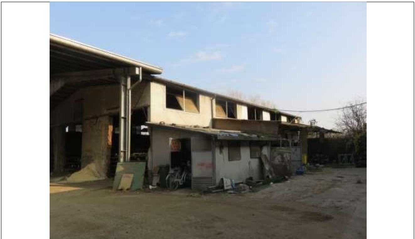
62 Particolare dei manufatti abusivi oggetto di demolizione, addossati al lato Sud del fabbricato adibito a ricovero attrezzi e fienile attualmente stilizzato a ricovero animali;
