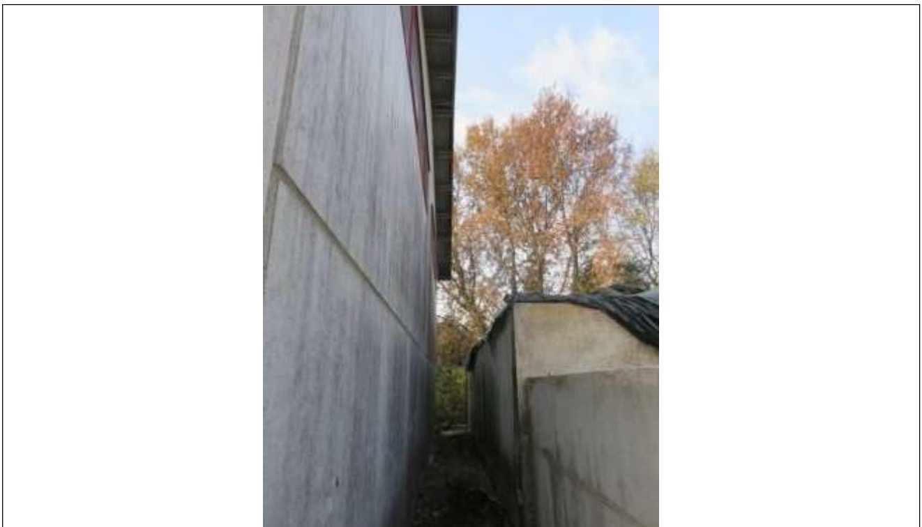
58 Vista del fronte Nord dell'immobile 4 – si nota la presenza della concimaia in muratura costruita abusivamente ed oggetto di demolizione;
