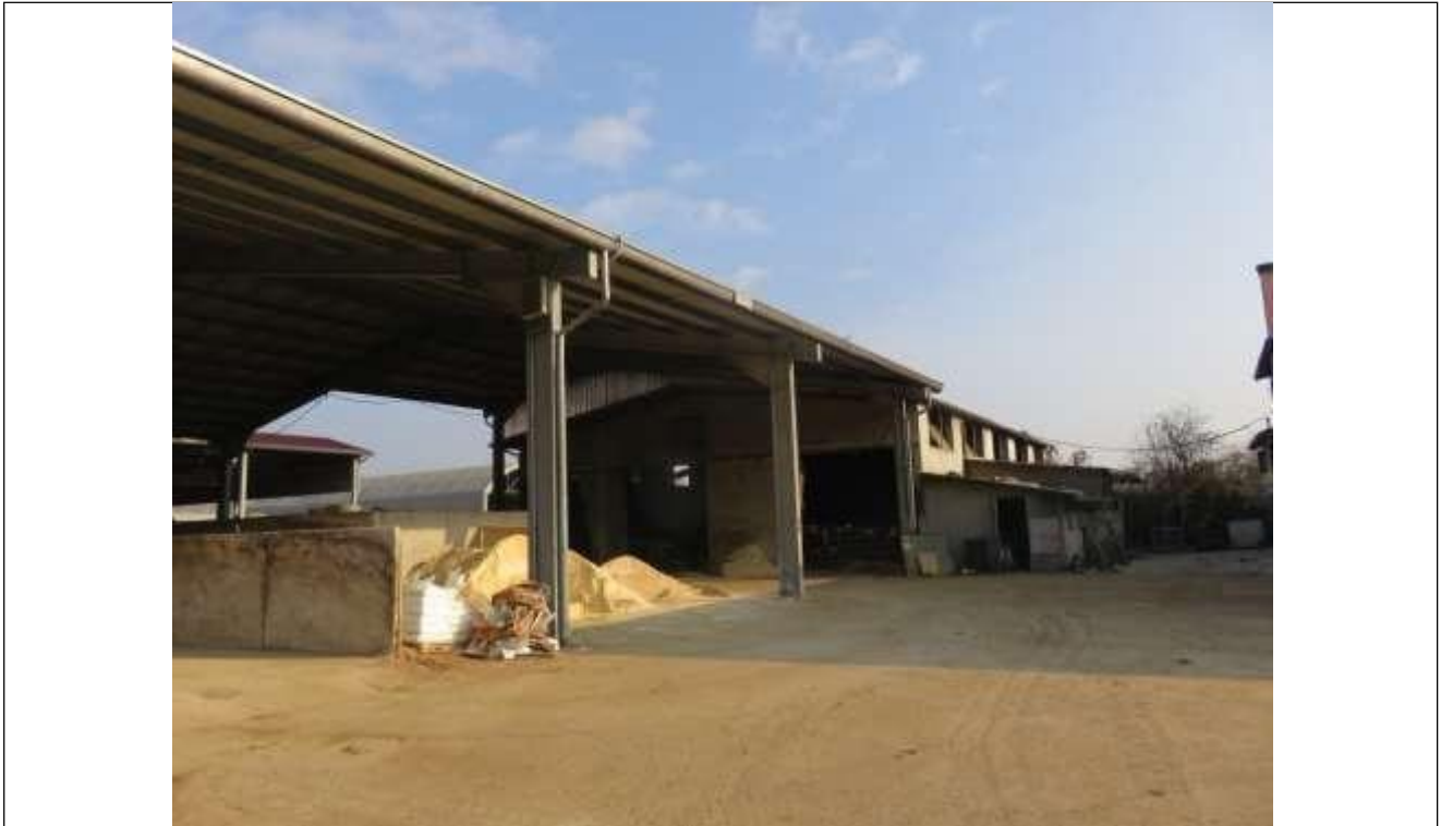
61 Altra vista della tettoia dal lato Sud e del fabbricato attualmente adibito a stalla; si notano addossate alla parete Sud, alcune baracche abusive oggetto di demolizione;
