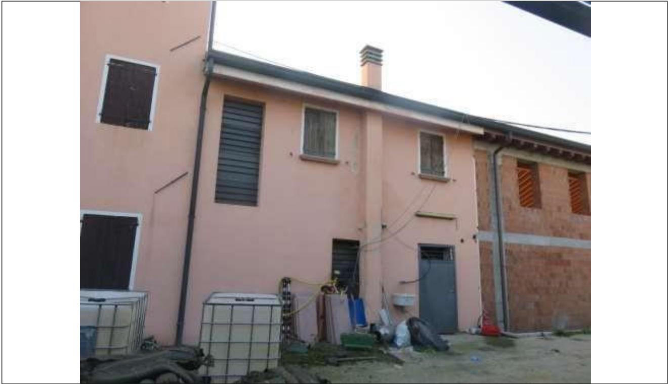
67 Altra vista del fronte Nord dell'abitazione e della porta di accesso alla centrale termica;
