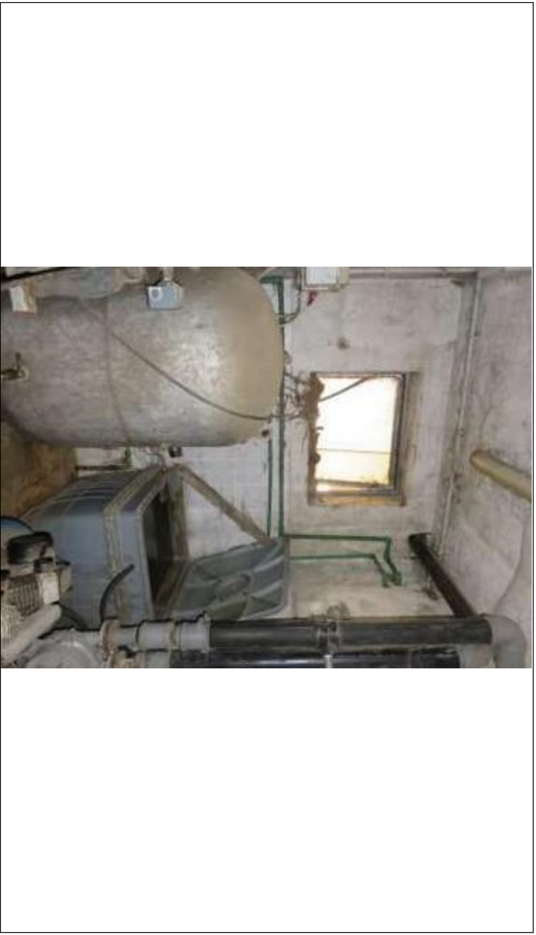
93 Vista di una sala macchine;
