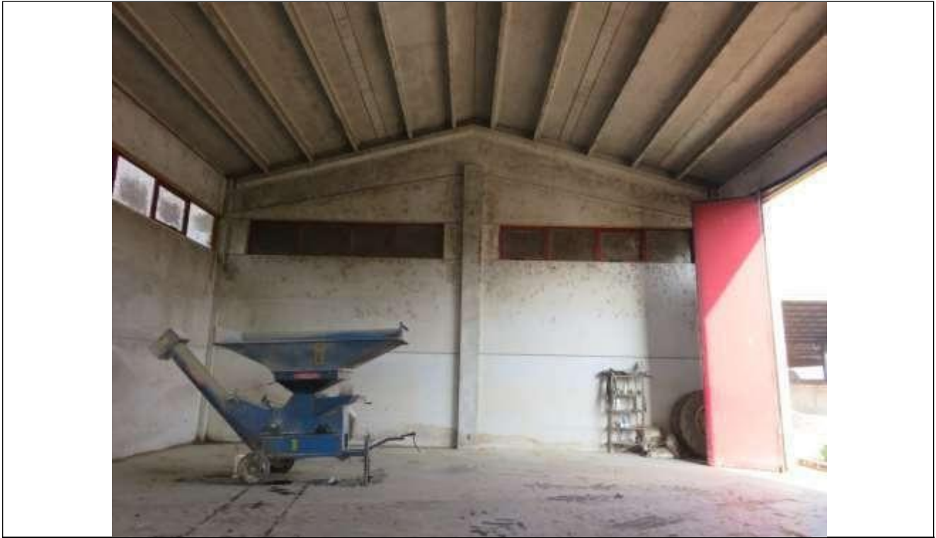
55 Altra vista dell'immobile 4, si nota il nastro di finestre da chiudere come indicato nella pratica edilizia rilasciata;
