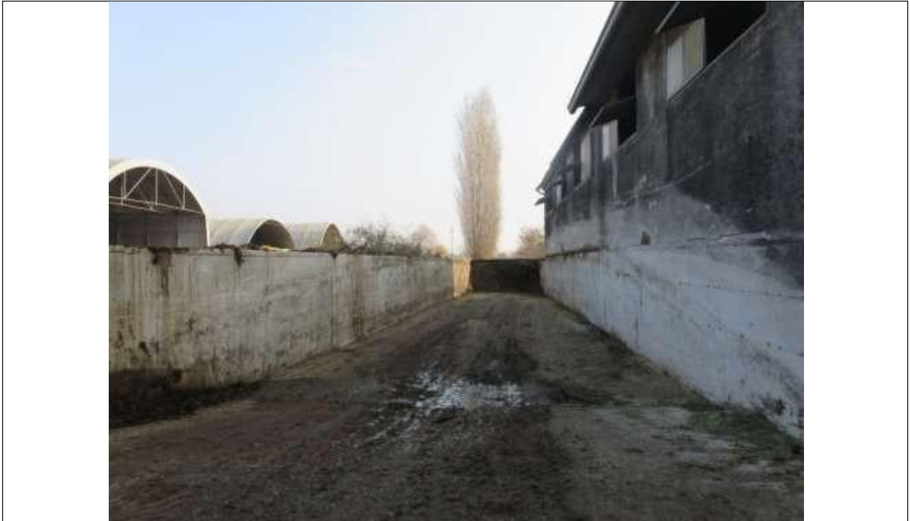
73 Vista del silo in muratura posizionato lungo il fronte Nord del ricovero attrezzi-fienile attualmente adibito a stalla;
