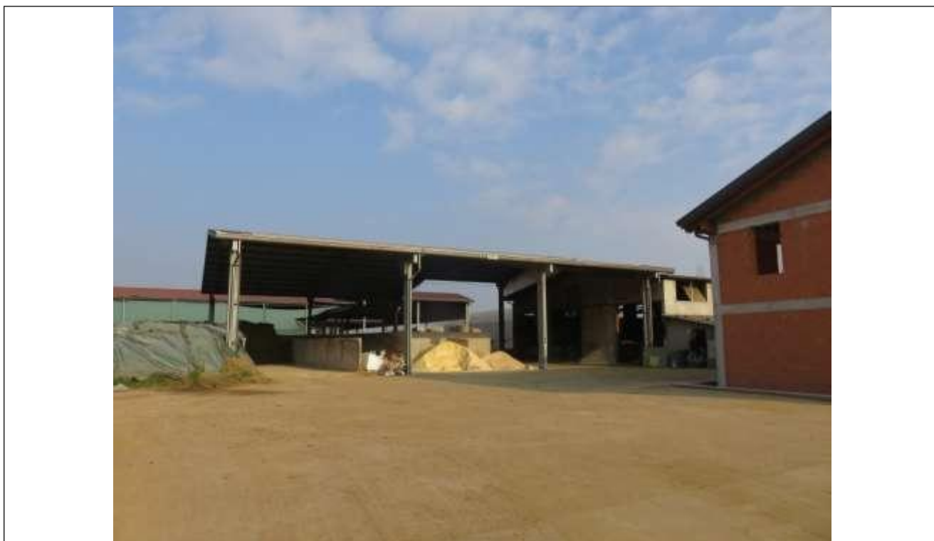
60 Vista di parte dell'immobile 5: tettoia coperta aperta su tre lati posta parzialmente a protezione della concimaia;
