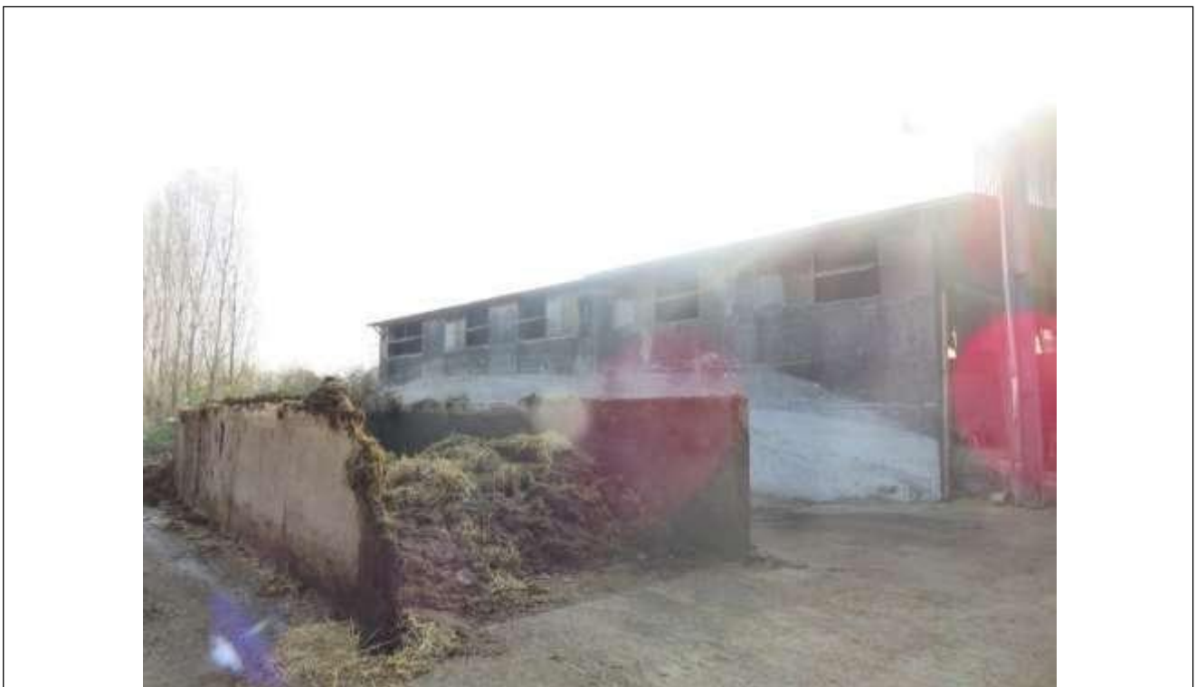
74 Vista della concimaia abusiva costruita in continuità al silo ed oggetto di demolizione;
