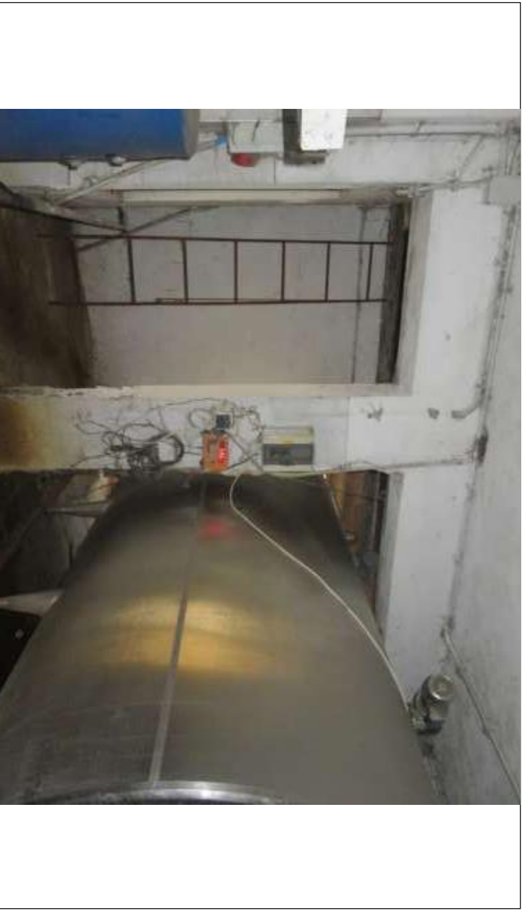
94 Vista della sala macchine ampliata;
