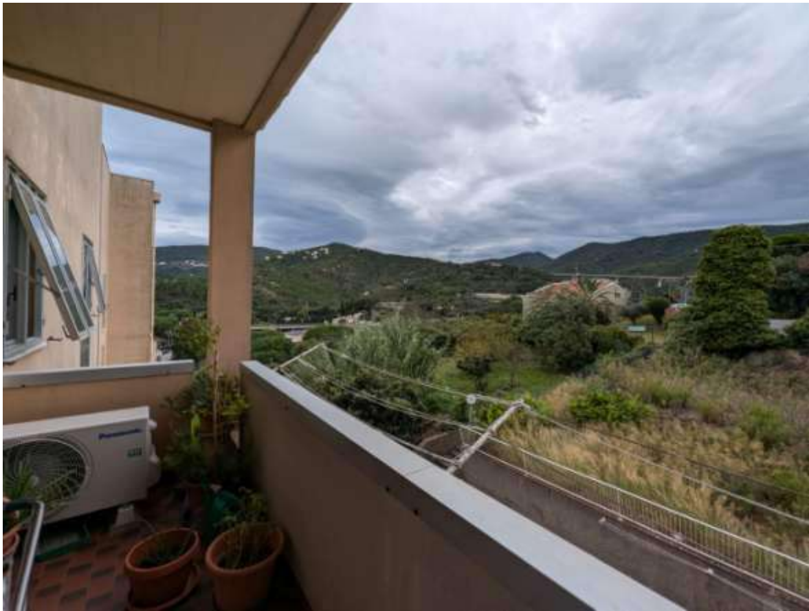
Fotografia 12: balcone lato monte
