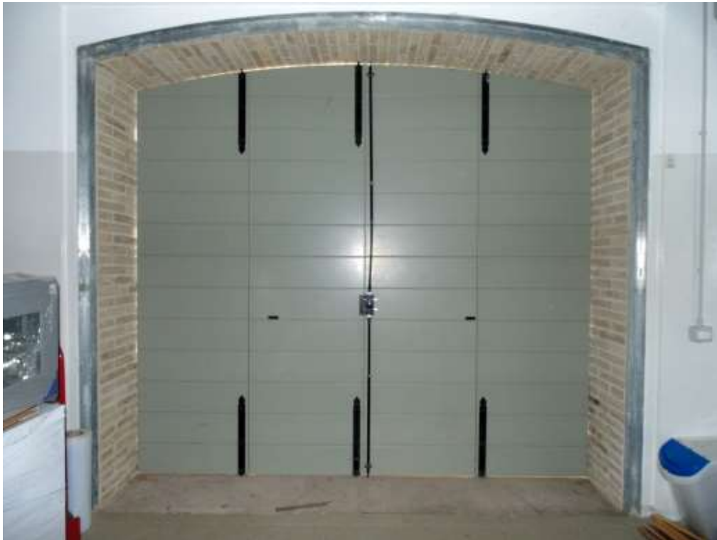
Foto n° 58 Interno Piano Terra - vista interna portone del laboratorio sul prospetto Nord - Est
