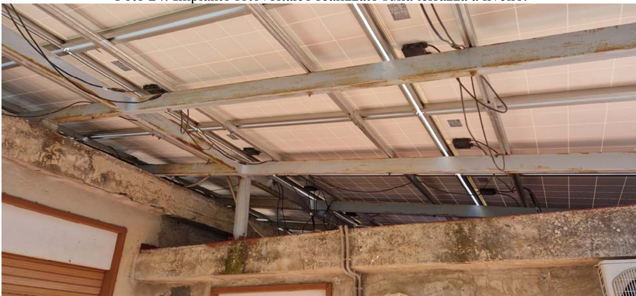
Foto 25: Impianto fotovoltaico realizzato sulla terrazza a livello.
