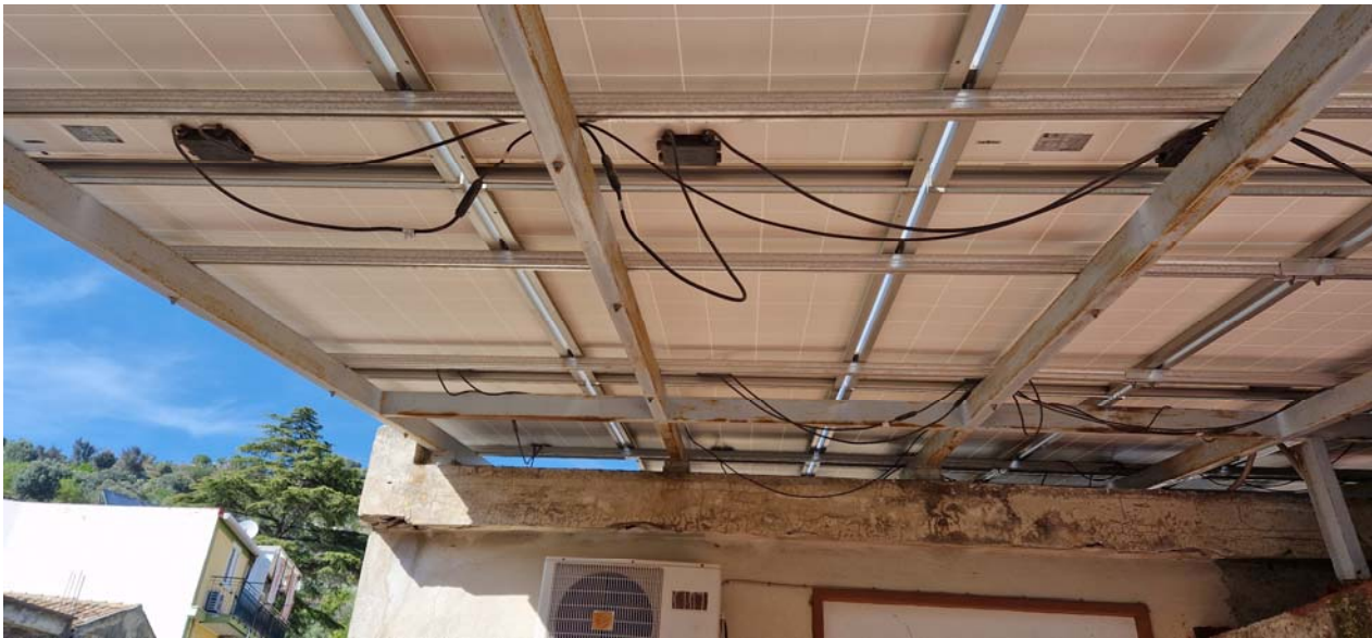
Foto 24: Impianto fotovoltaico realizzato sulla terrazza a livello.
