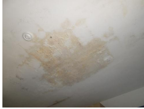
Evidenze di infiltrazioni a soffitto
