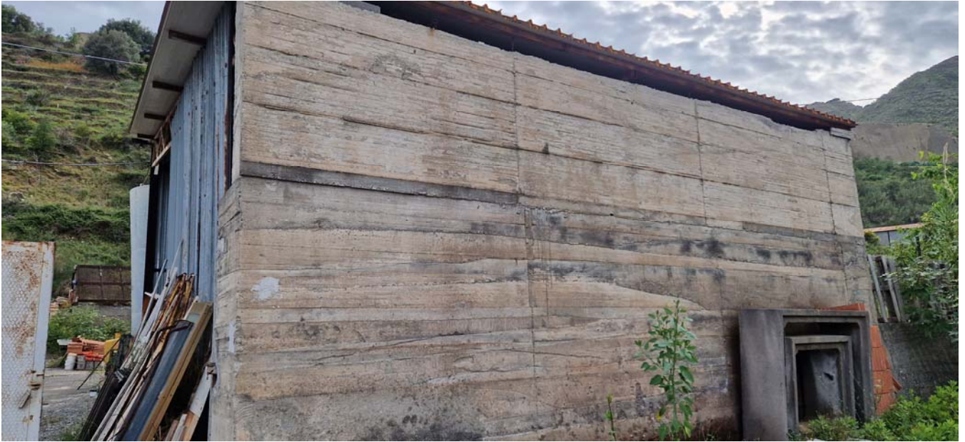
Foto 7: Fabbricato realizzato abusivamente sul terreno Furci Siculo Foglio 12 part. 237.
