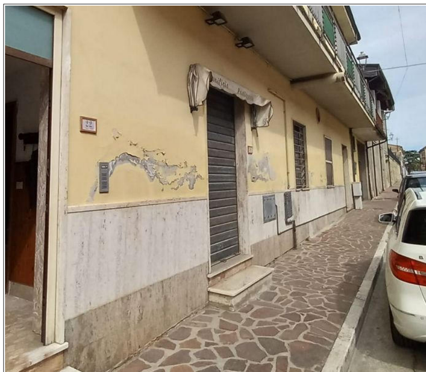
Umidità sulla parete fronte strada
