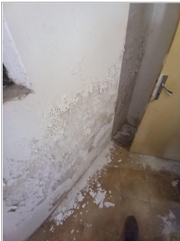
Umidità interna al piano terra
