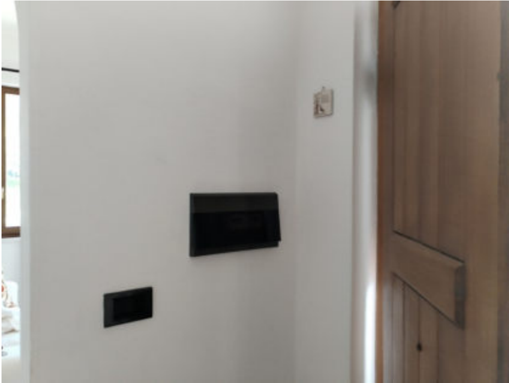
Foto n° 28: quadro elettrico di tutto il fabbricato
