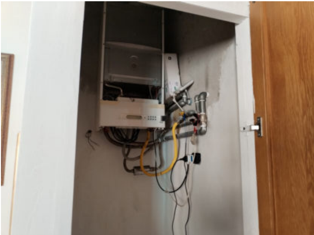
Foto n° 27: caldaia di tutto il fabbricato
