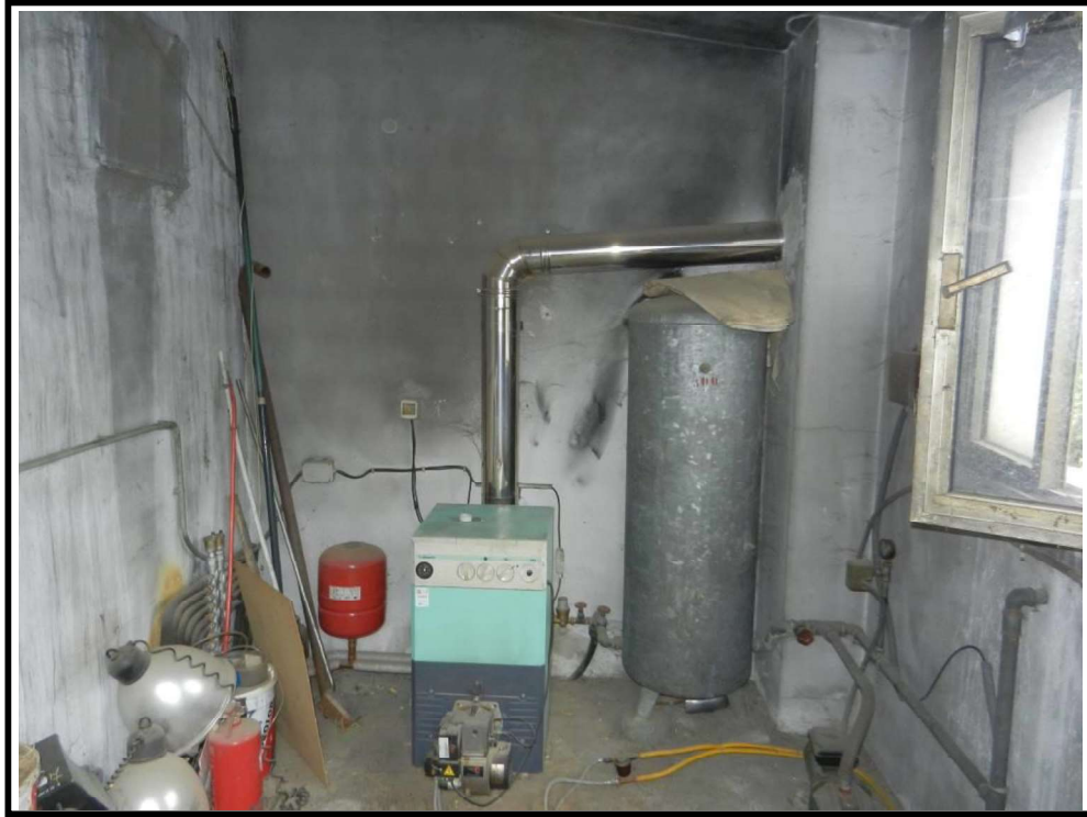
Foto 9 Locale centrale termica
