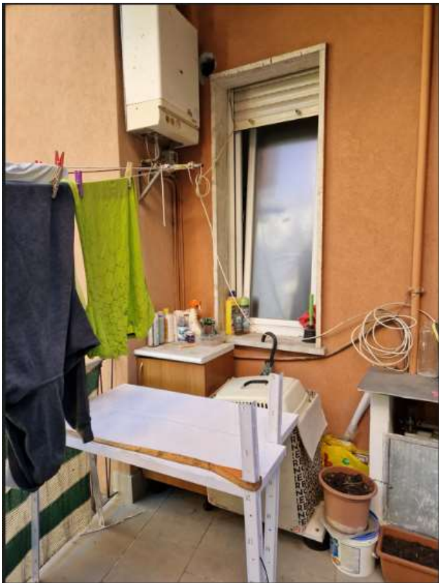
FOTO 21: Terrazzo: finestra bagno e scaldabagno
