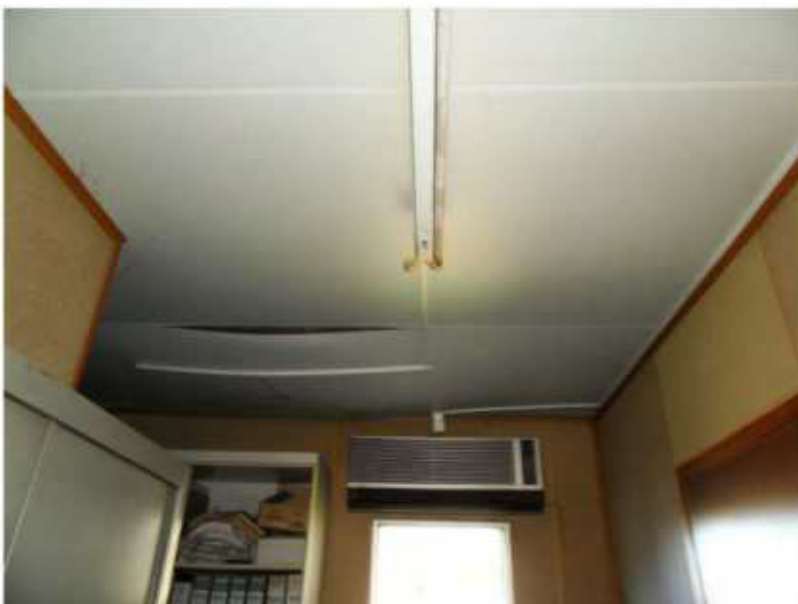
Foto 35A: Controsoffitto disimpegno
