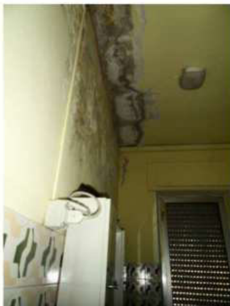
Foto 20A: Casa del custode - Dettaglio intradosso solaio bagno
