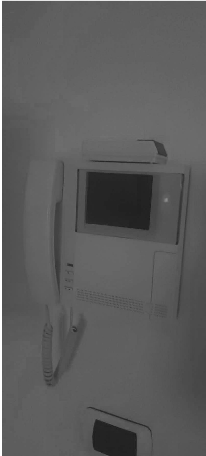
Foto n. 20 Impianto citofonico - particolare
