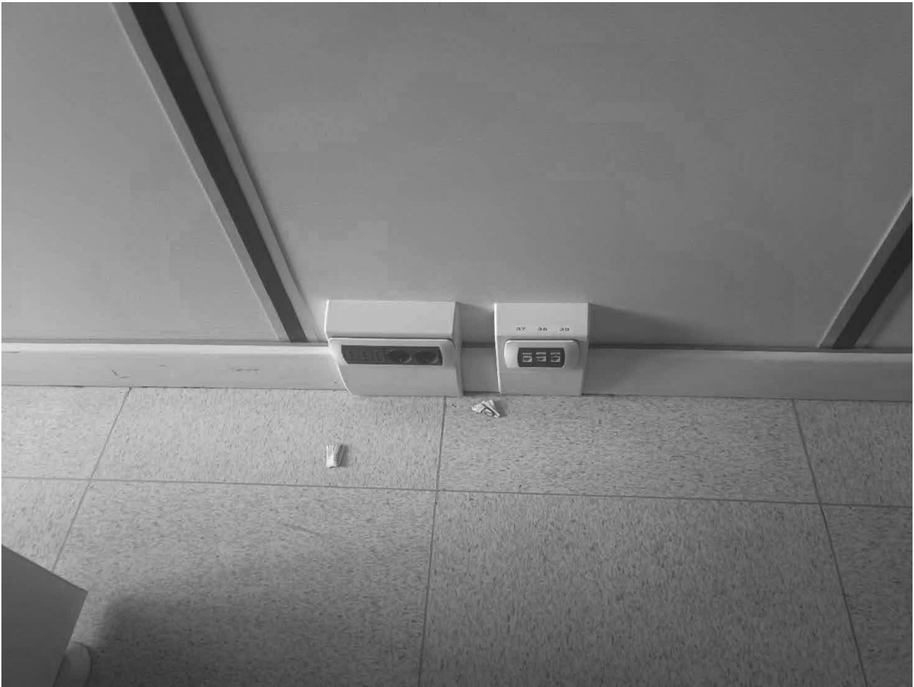
Foto n. 18 Impianto elettrico - particolare
