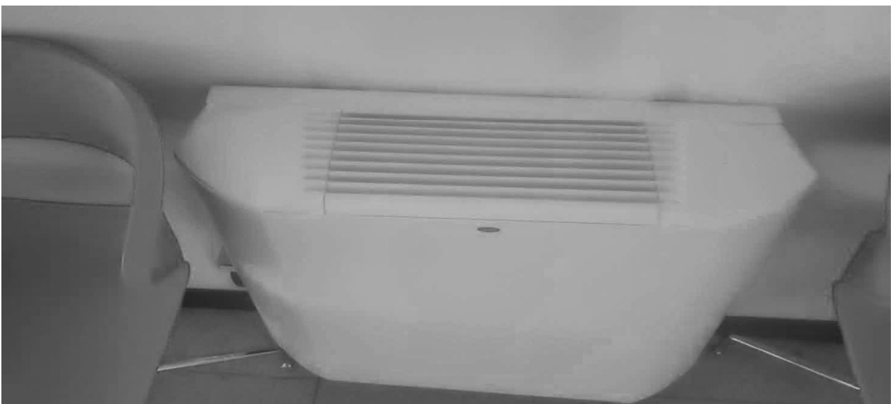
Foto n. 19 Diffusore aria fredda/calda - particolare
