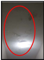
Foto n.24-w.c. -intonaco ammolorato evidenziato
