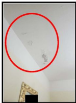
Foto n.16-Stanza da letto-intonaco ammalorato evidenziato
