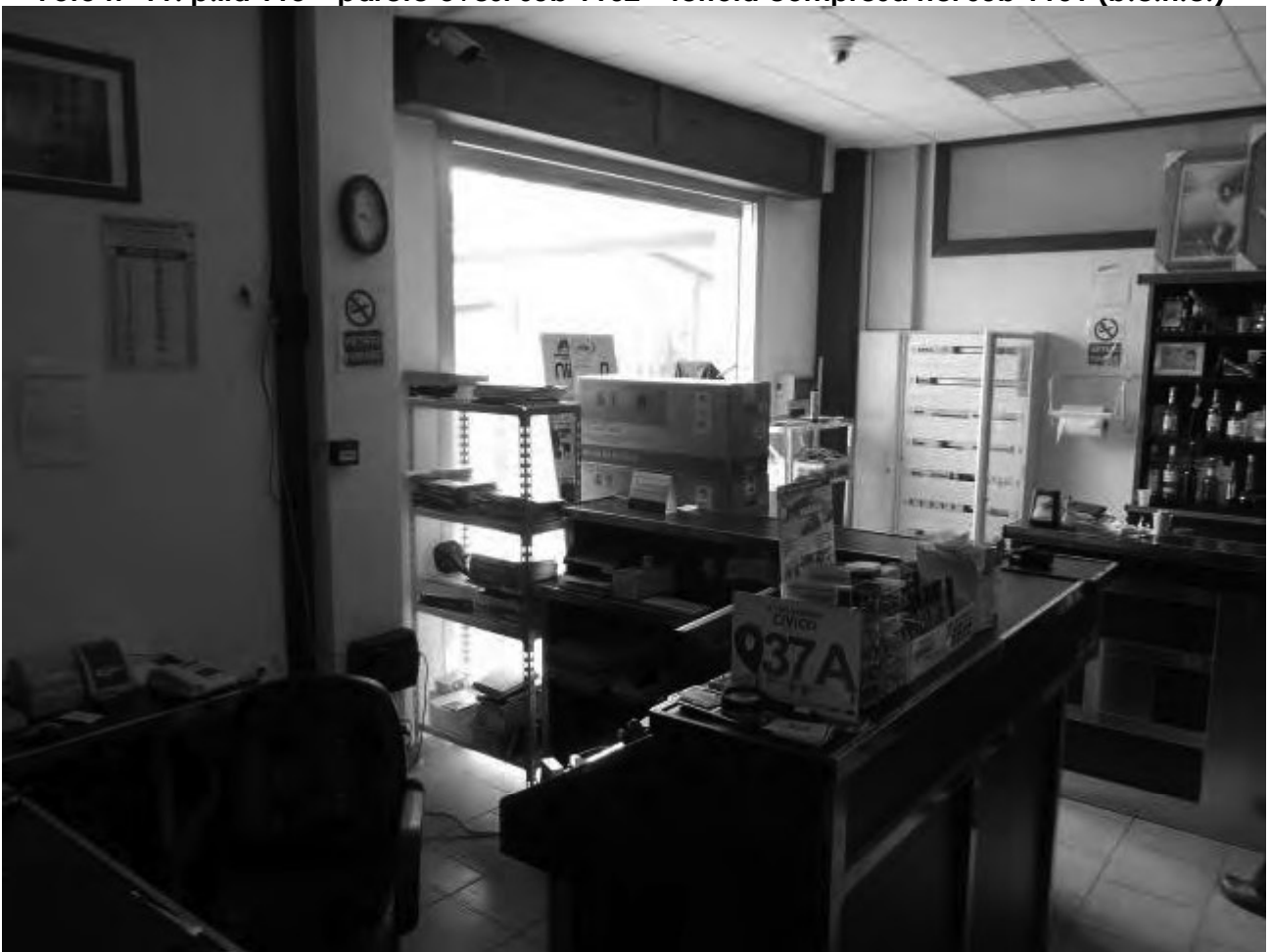
Foto n° 12: p.lla 113, sub 1102 – vetrata (ex accesso al bene)
