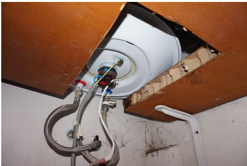
Foto 39 – L'ubicazione del boiler all'interno del ripostiglio
