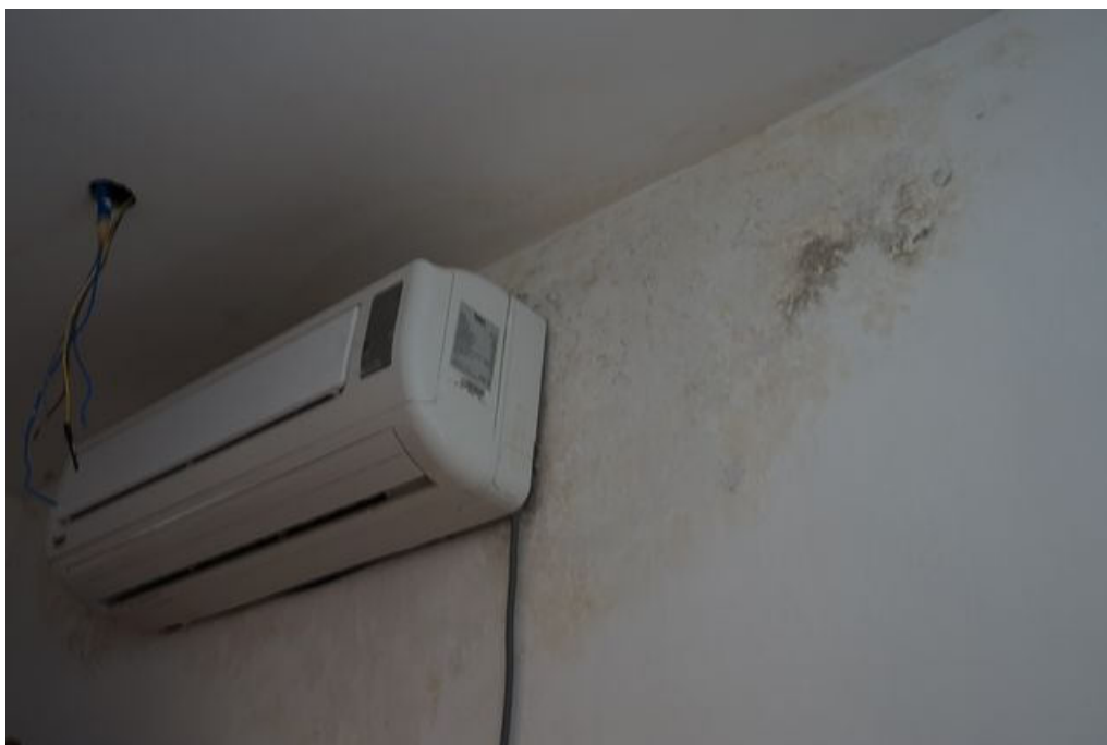
Foto 41 – L'umidità e la muffa presente sui muri del piano primo
