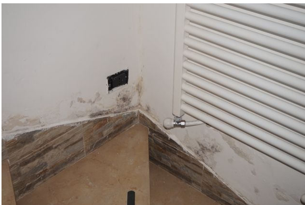
Foto 42 – L'umidità e la muffa presente sul muro della scala
