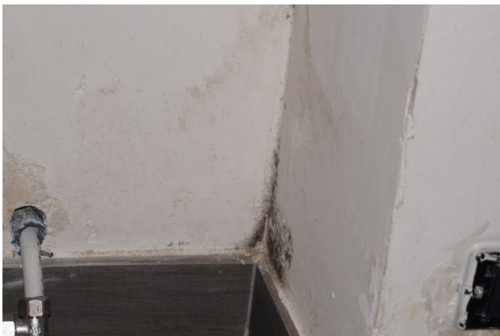
Foto 40 – L'umidità e la muffa presente in tutto il piano terra
