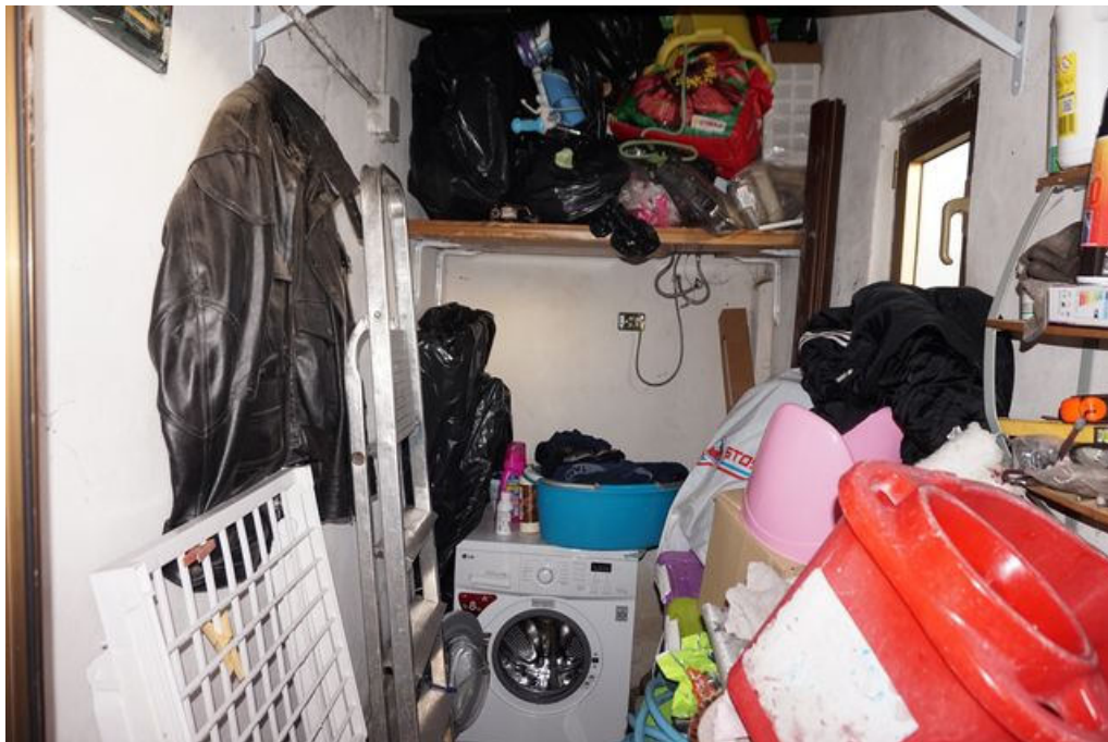
Foto 38 – Il ripostiglio, dove è inserito il boiler per la produzione dell'acqua sanitaria
