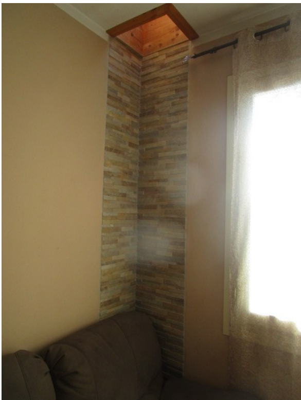
Figura 27: Bucatura del solaio, non prevista in concessione, per il passaggio di una canna fumaria.
