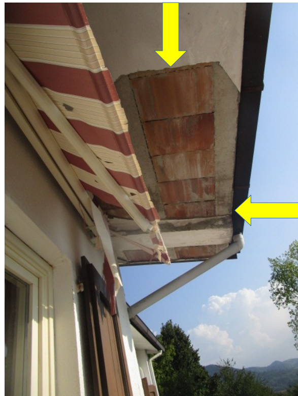
Figura 26: Particolare della carenza manutentiva, dello sporto del coperto.
