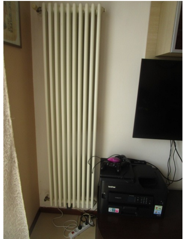
Figura 10: Tipologia delle masse radianti, in acciaio verniciato, alimentate da caldaia a gas.
