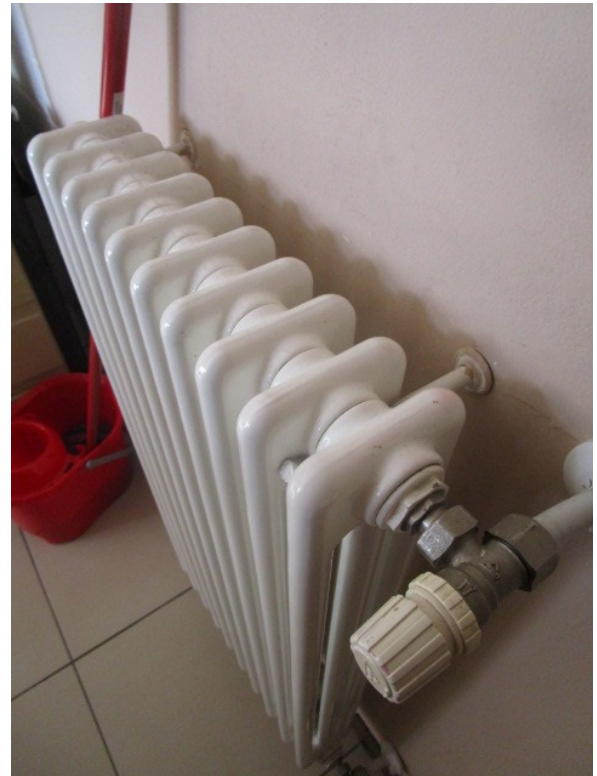
Figura 22: Masse termiche, sprovviste di valvola termostatica.
