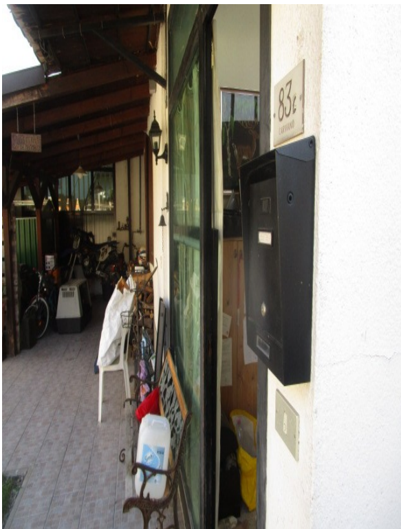
Figura 3: Tettoia in aggetto, sul fronte d'ingresso all'abitazione, difforme dai progetti ed accatastamenti attuali.
