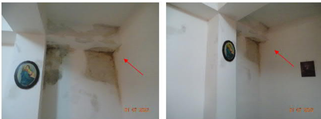
Figura 11: Danneggiamenti camera singola (pareti)
