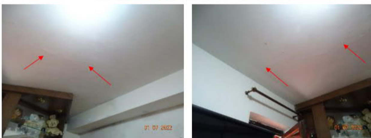
Figura 12: Danneggiamenti camera singola (soffitto)
