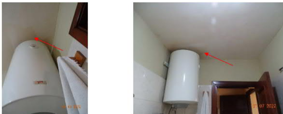
Figura 14: Danneggiamenti servizio igienico
