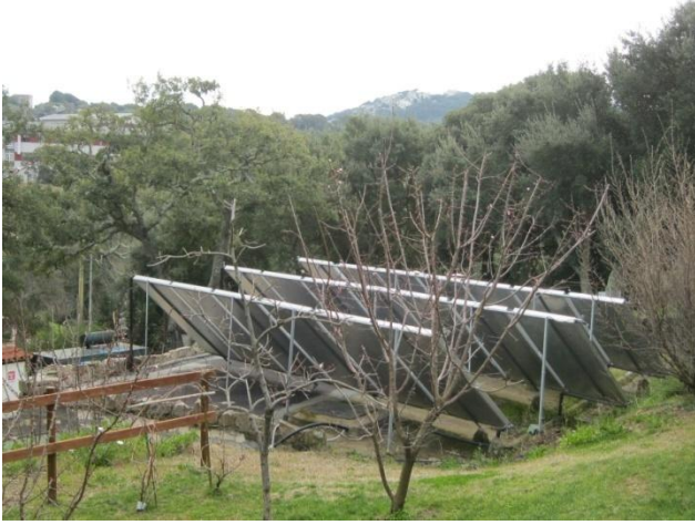
IMPIANTO SOLARE TERMICO
