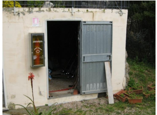
LOCALE TECNICO SOTTO PISCINA
