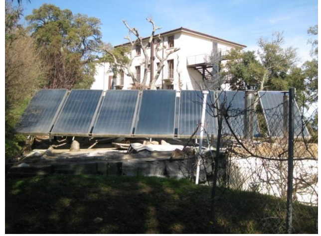
IMPIANTO SOLARE TERMICO
