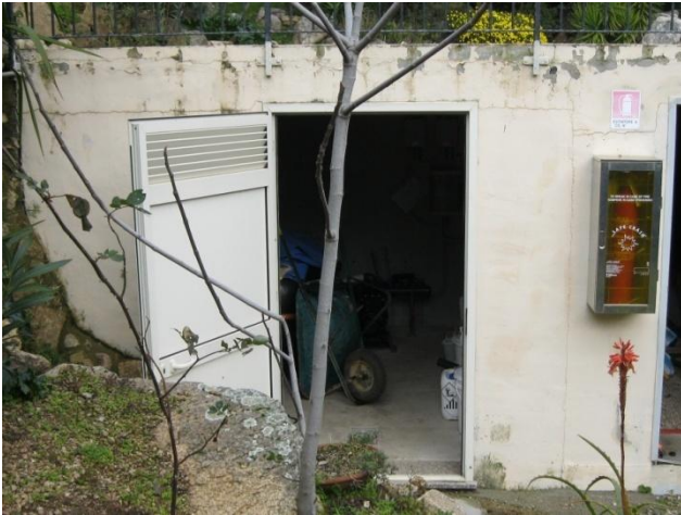
LOCALE TECNICO SOTTO PISCINA
