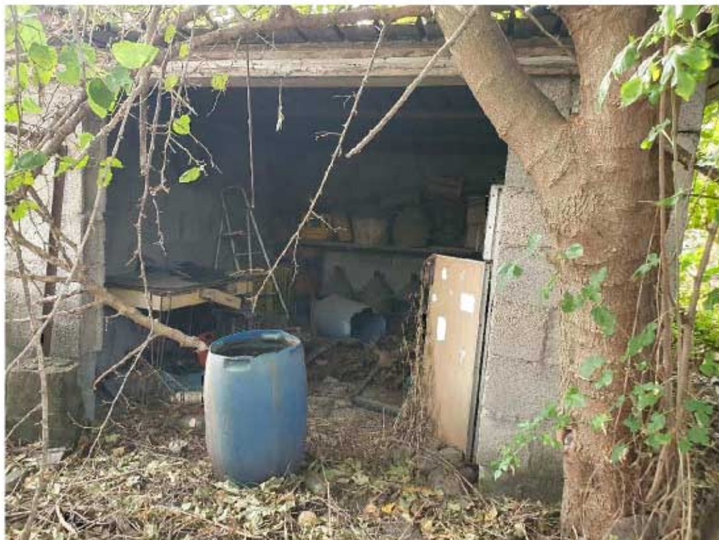
Fotografia – Immobile realizzato senza autorizzazione.
