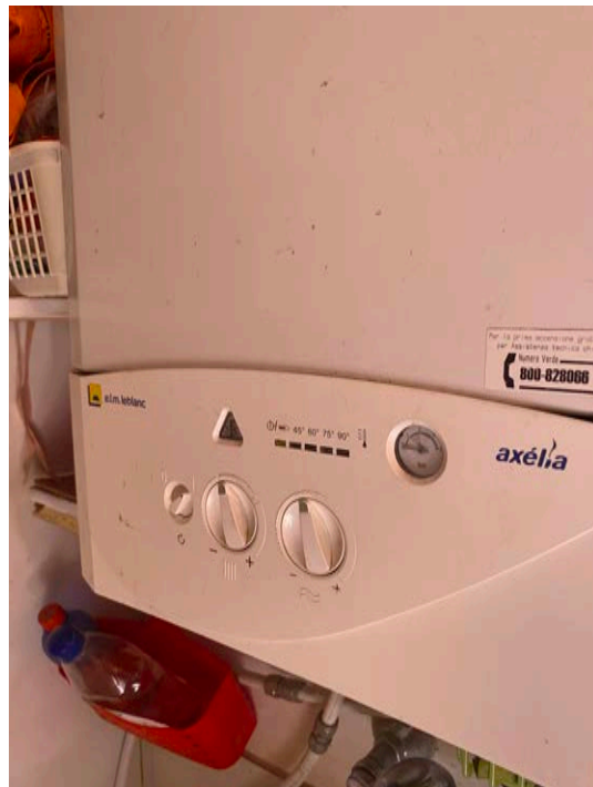
FOTO 21- PARTICOLARE DELLA CALDAIA
