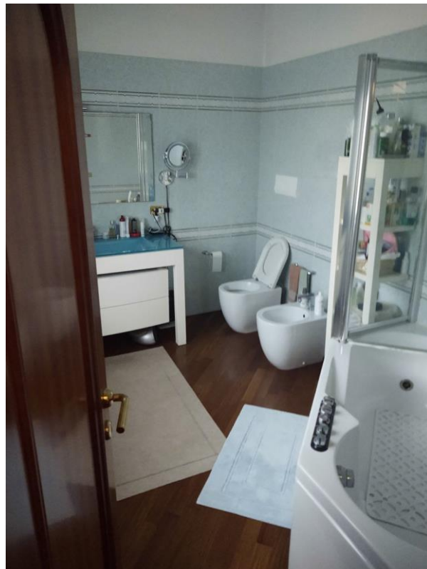
Figura 6 - wc piano primo
