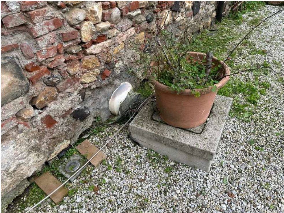
Pozzetto fognario su proprietà di terzi.
