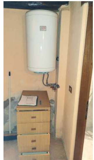
Boiler per ACS
