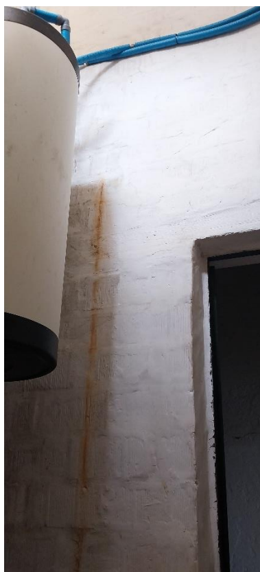
Foto 13. Locale tecnico accessibile dal garage. Boiler.
