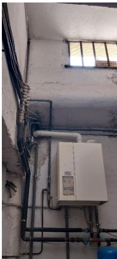
Foto 12. Locale tecnico accessibile dal garage. Caldaia.
