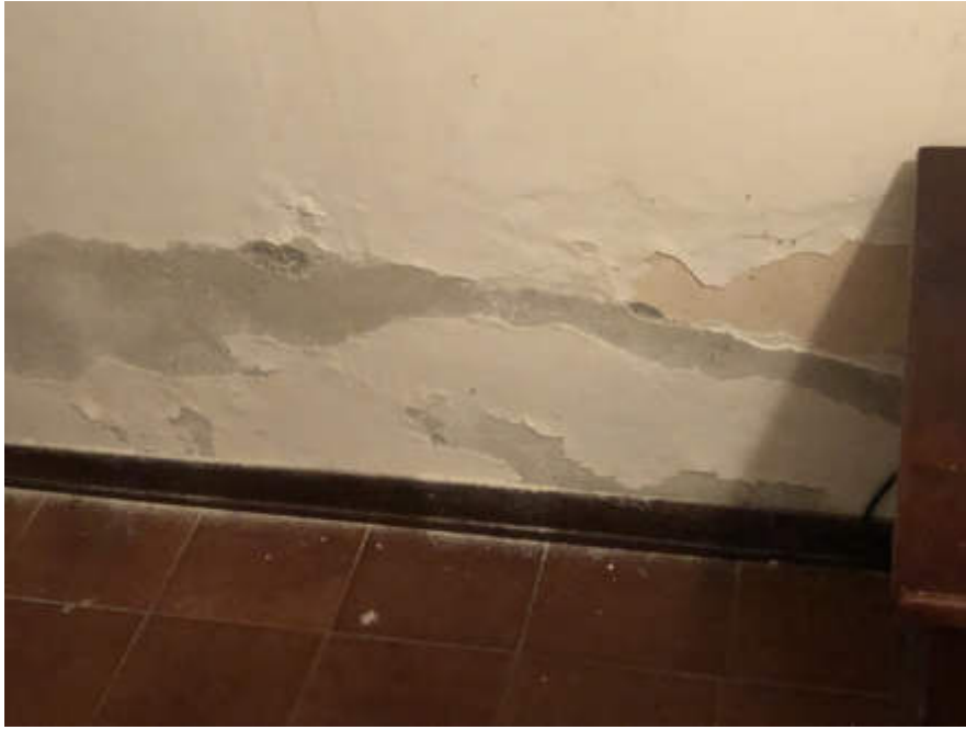
Degrado provocato dall'umidità lungo le pareti del corridoio
