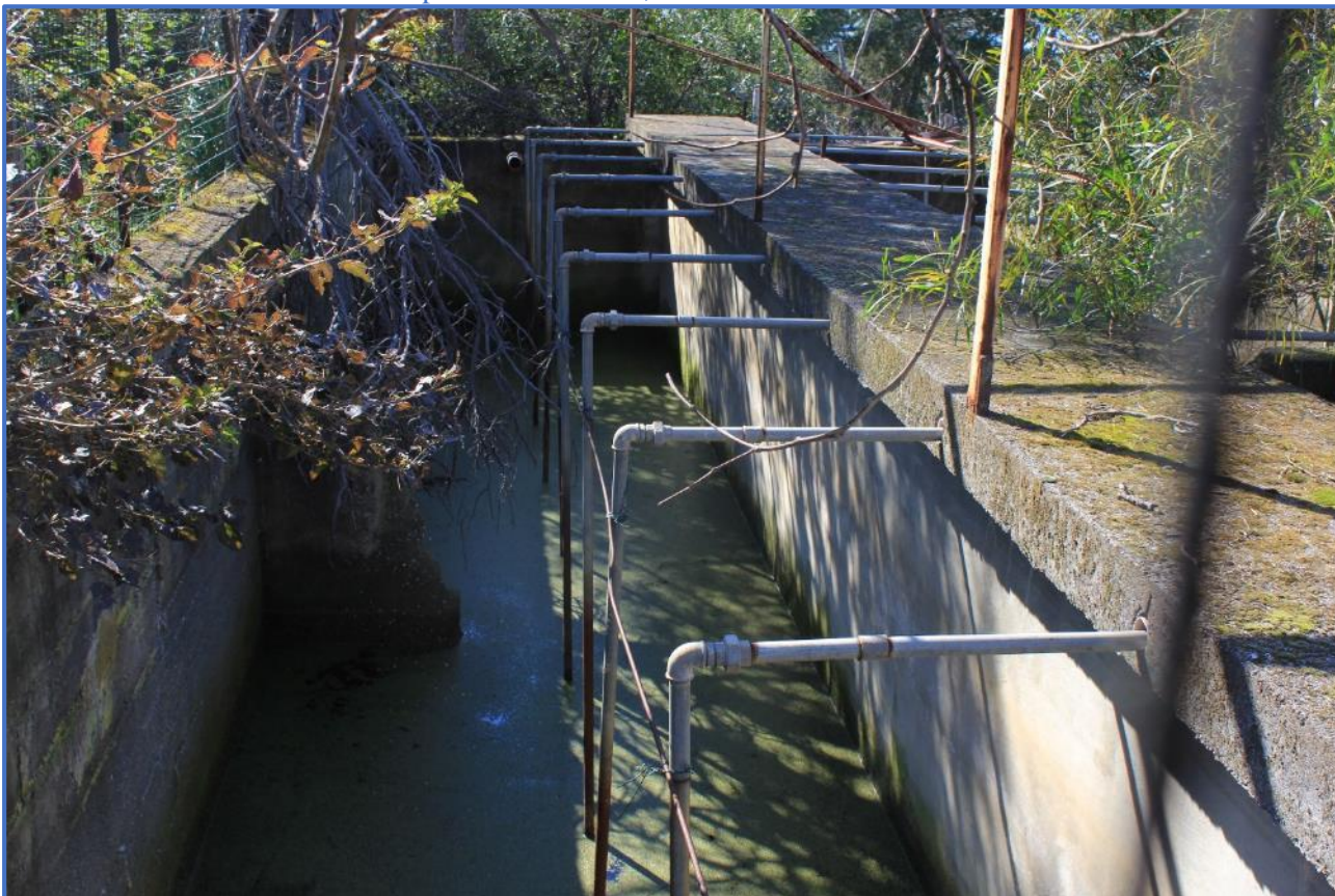
3.10 – Particelle nn. 675-673 – Depuratore dismesso, vista dello stato di abbandono della struttura
