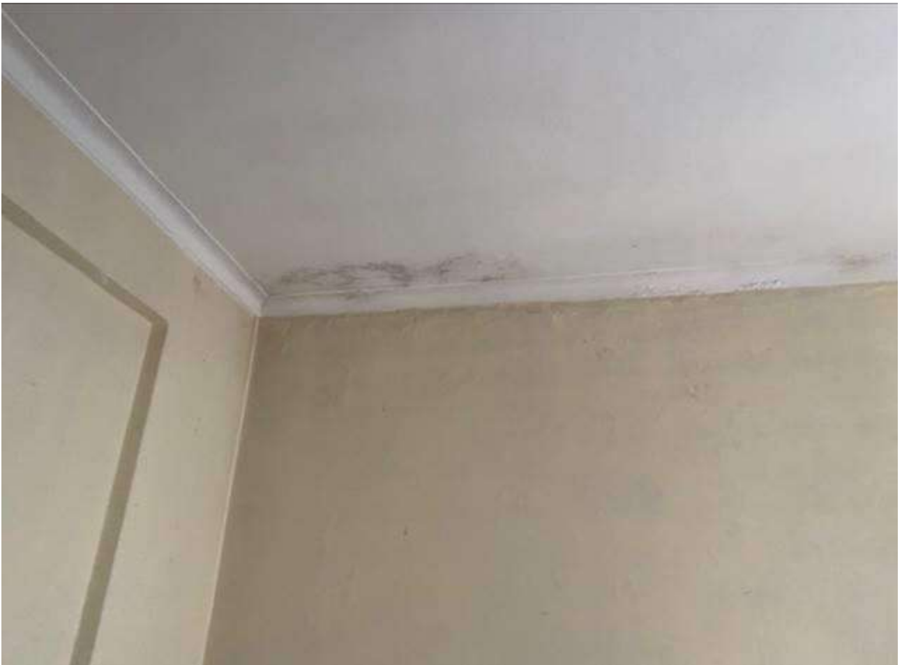
Foto 35 e 36 – Dettaglio della zona di umidità nella Camera 2
