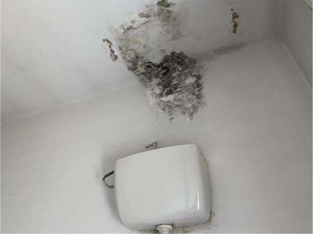
Foto 41 – Dettaglio della zona di umidita nel bagno
