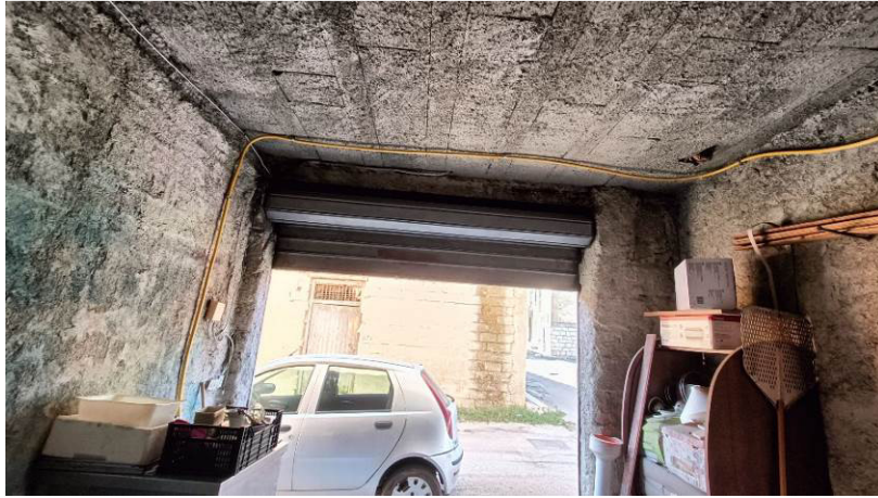
Tubazione gas proveniente dall'esterno e verso l'appartamento sub 1
