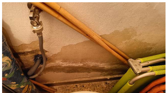
Umidità di risalita sottoscala
