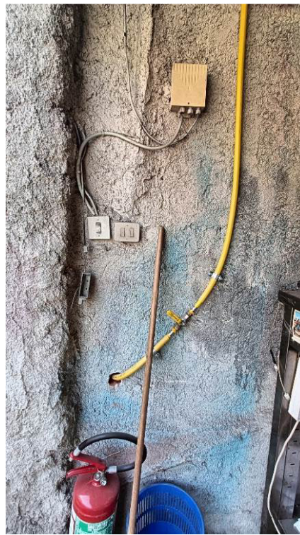
Tubazione gas proveniente dall'esterno e verso l'appartamento sub 1
