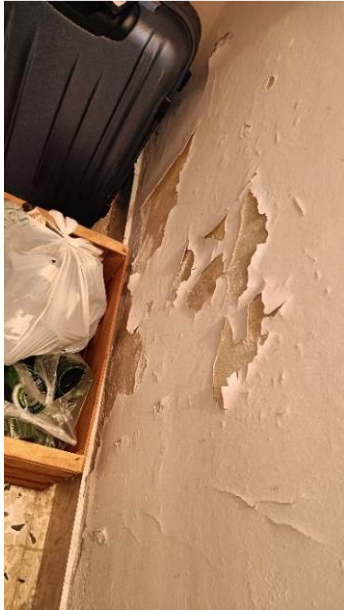
Umidità di risalita disimpegno sottoscala
