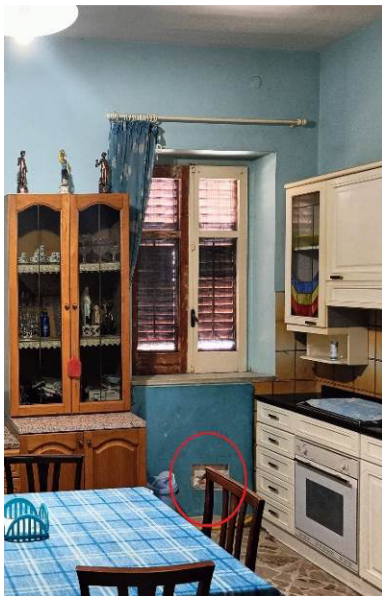
Rottura tubazione di scarico
