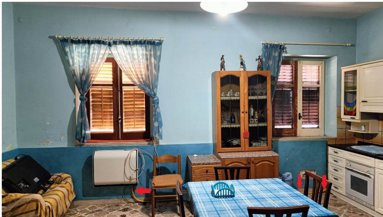
Tubazione gas proveniente dal magazzino Sub 2
