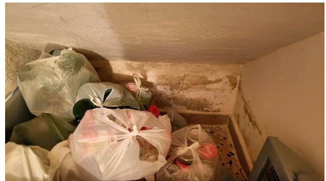
Umidità di risalita sottoscala
