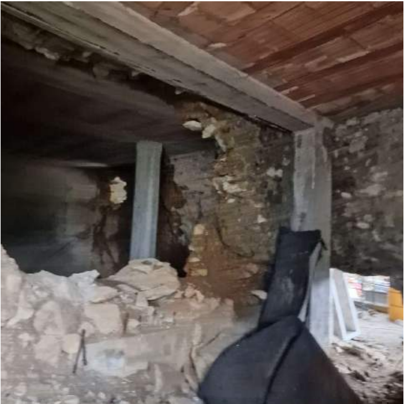
FOTO 21 STATO MURATURE ANTICA FORNACE
