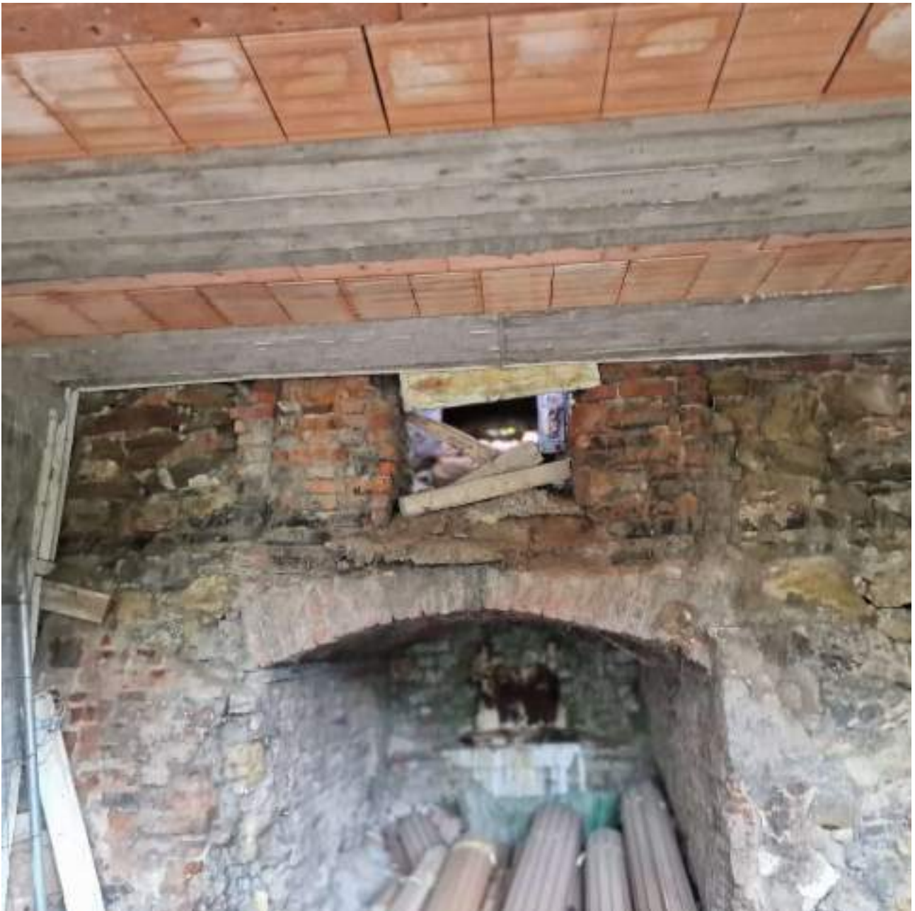
FOTO 20 STATO MURATURE ANTICA FORNACE
