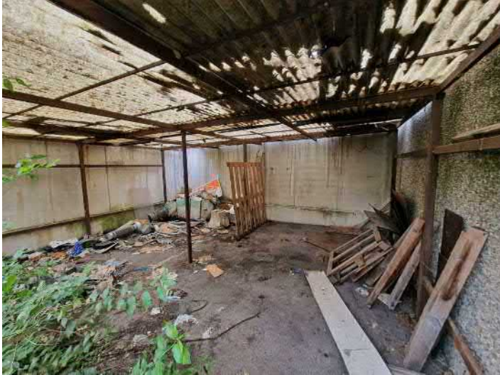
Tettoia non autorizzata
