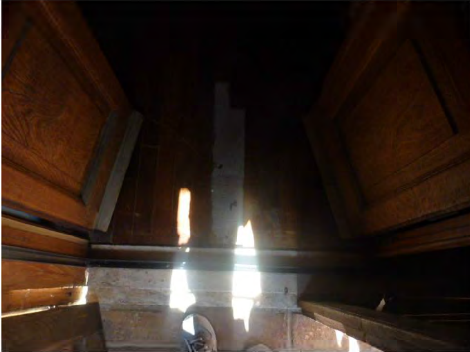
Foto n. 26: Problemi di umidità riscontrati
