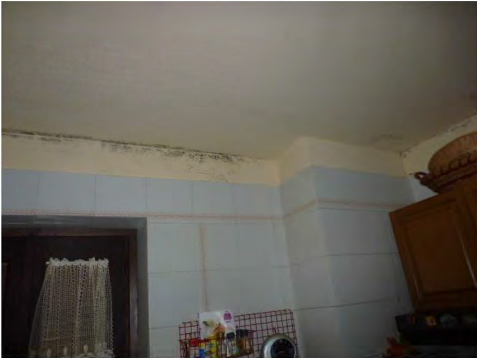
Foto n. 26: Problemi di umidità riscontrati
