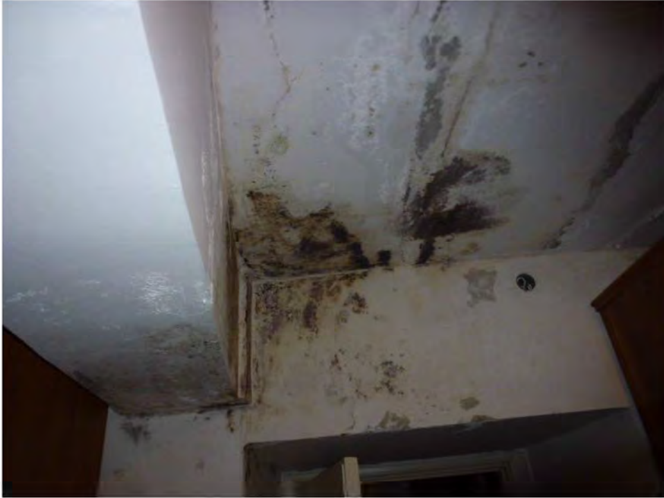
Foto n. 25: Problemi di umidità riscontrati
