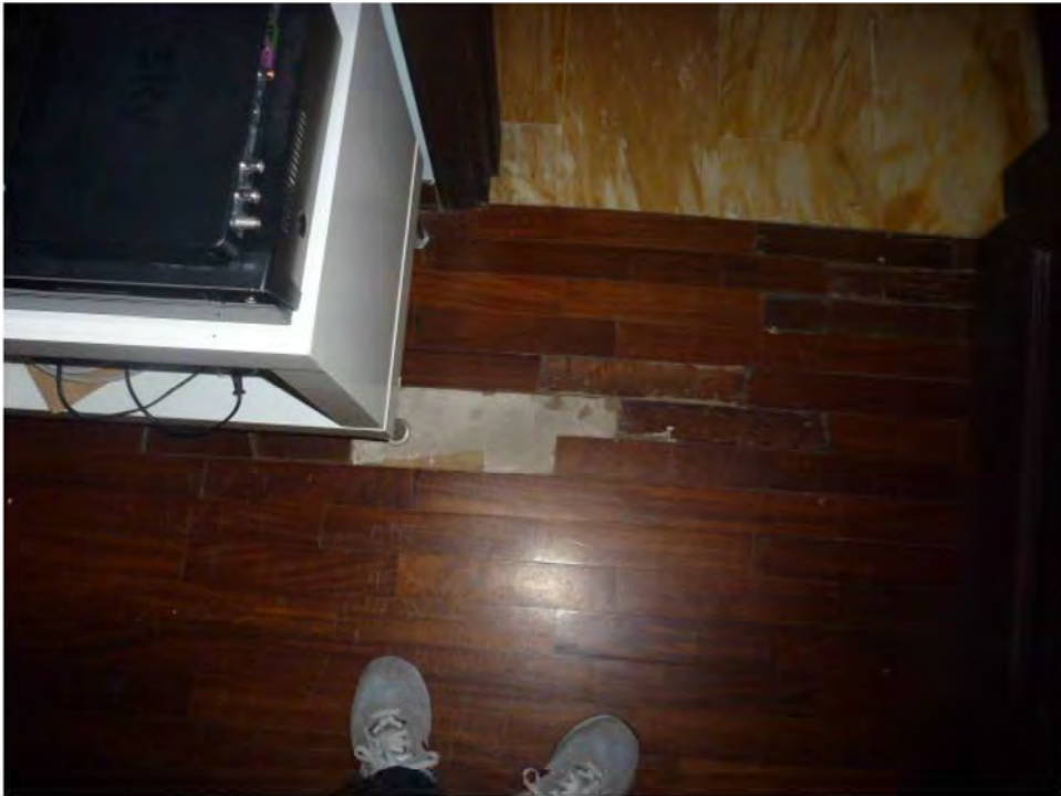
Foto n. 27: Problemi di umidità riscontrati
