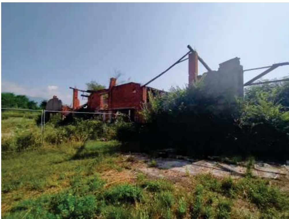
9. Foto: opificio, struttura crollata verso confine nord
