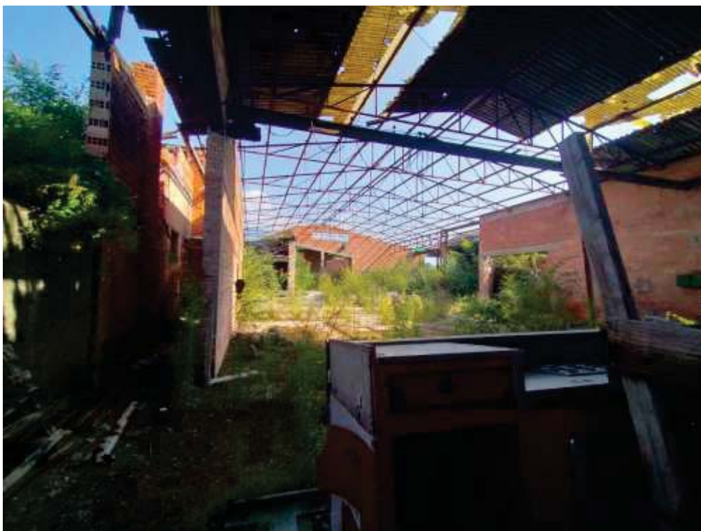
10. Foto: opificio, struttura crollata lato nord-est
